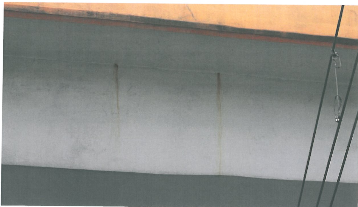
Fot. 121. Widoczne rdzawe zacieki na bocznej powierzchni ustroju nośnego w przęśle skrajnym na estakadzie zachodniej spowodowane zbyt małą otuliną.
