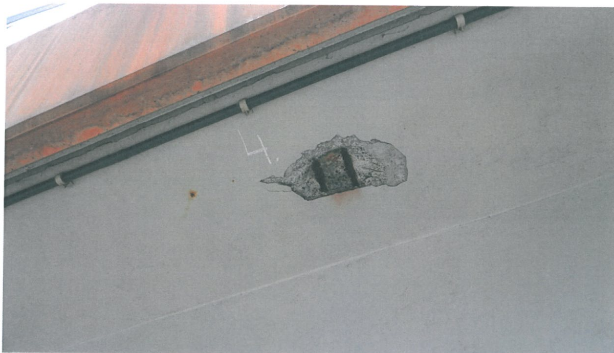
Fot. 152. Odkrywka nr 4 w prześle P13-P14 estakady wschodniej – Usunięcie otuliny odsłania mocno skorodowane pręty zbrojeniowe.
