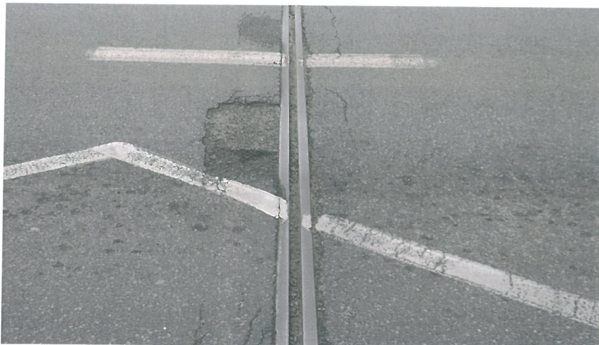
Fot. 93. Widoczne duże zanieczyszczenie wkładki dylatacyjnej na estakadzie zachodniej od strony Katowic spowodowane brakiem robót utrzymaniowo-porządkowych.
