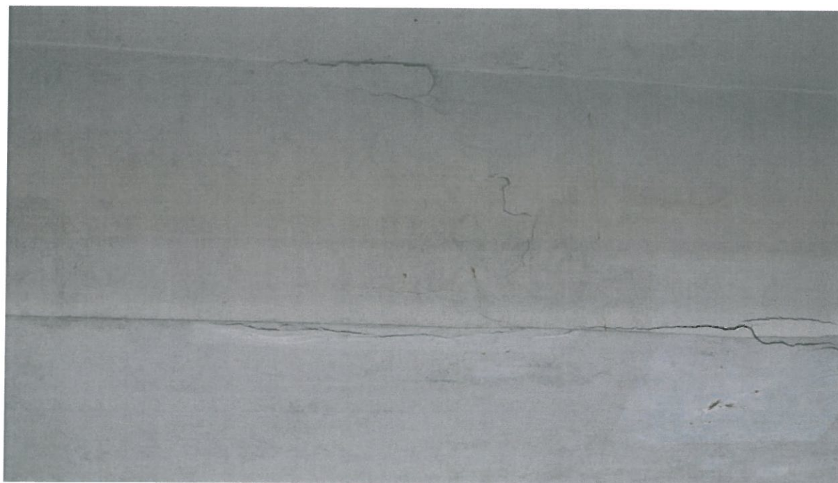
Fot. 60. Widoczne odspojenia oraz spękania powierzchni bocznej, dolnej, wewnętrznej ustroju nośnego w przęśle pomiędzy podporami P12-P13 estakady wschodniej spowodowane korozją prętów zbrojeniowych.
