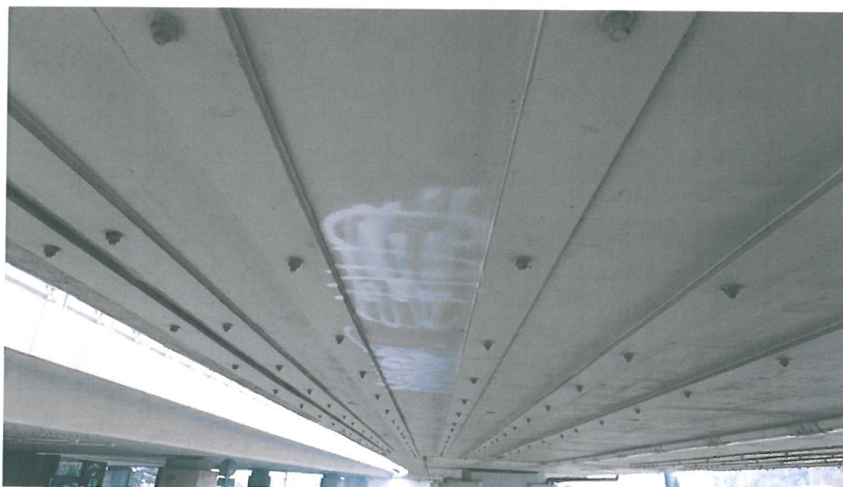
Fot. 68. Widoczne zanieczyszczenie w postaci graffiti powierzchni dolnej ustroju nośnego w przęśle skrajnym od strony Katowic na estakadzie wschodniej spowodowane celowym aktem wandalizmu.
