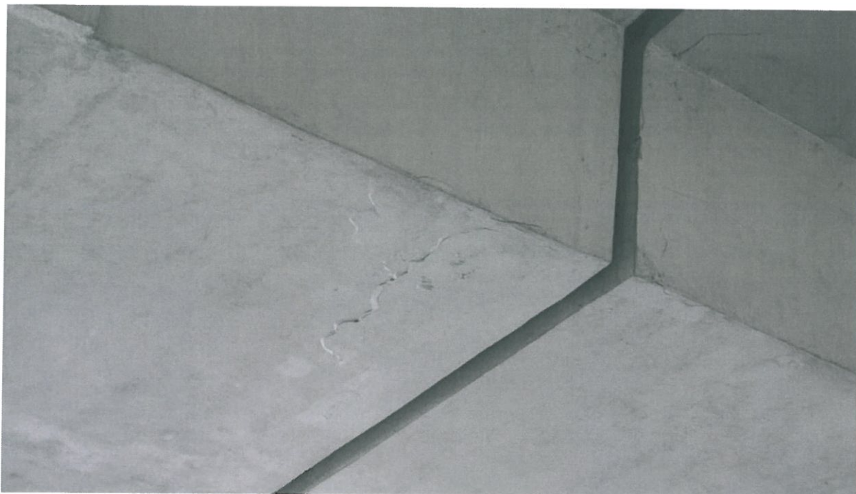
Fot. 51. Widoczne odspojenia dolnej powierzchni oraz spękania powierzchni bocznej ustroju nośnego w przęśle pomiędzy podporami P2-P3 estakady wschodniej spowodowane korozją prętów zbrojeniowych.
