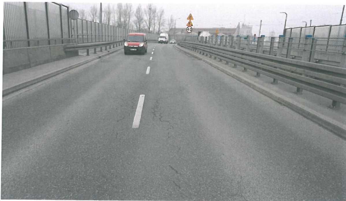
Fot. 83. Widoczne spękania nawierzchni asfaltowej w przęśle pomiędzy podporami P4-P5 estakady zachodniej spowodowane najprawdopodobniej intensywną eksploatacją i słabą jakością mieszanki asfaltowej.
