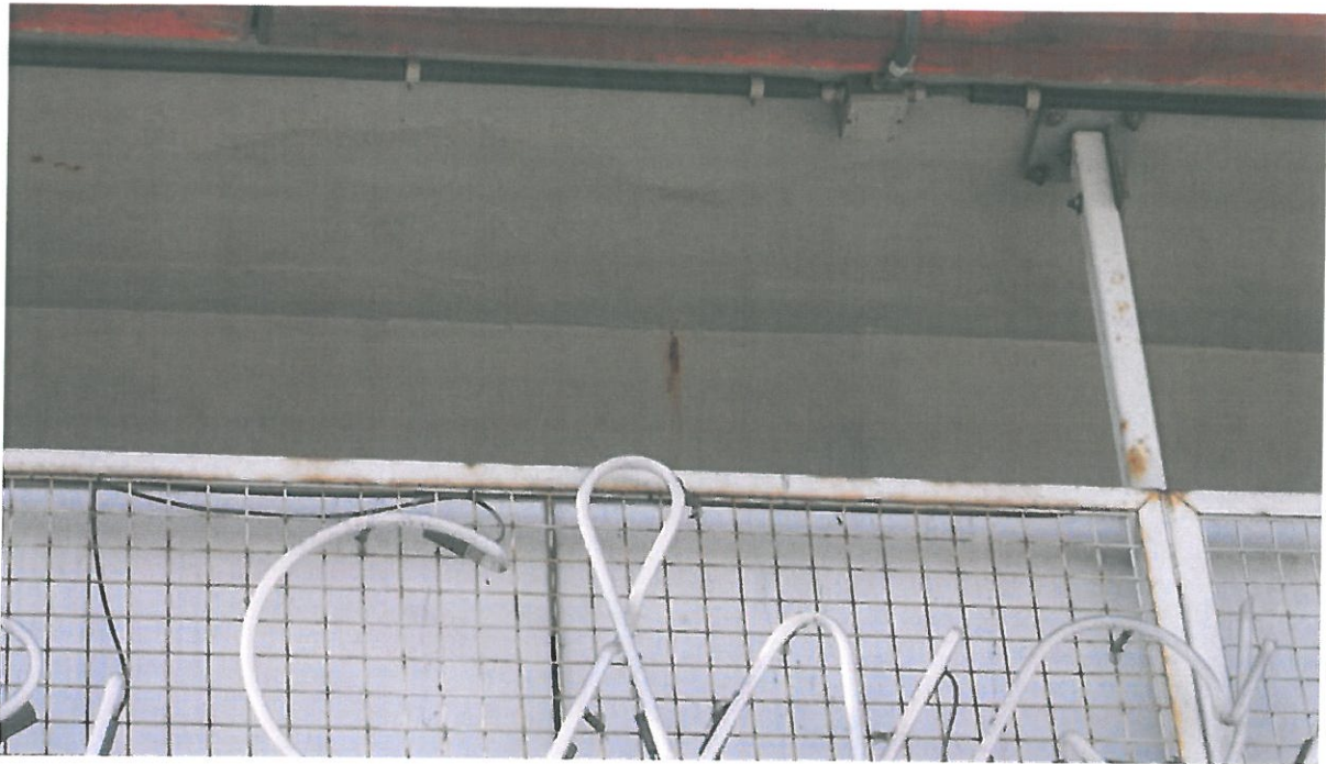
Fot. 37. Widoczne rdzawe zacieki na powierzchni bocznej, zewnętrznej ustroju nośnego w przęśle pomiędzy podporami P8-P9 estakady wschodniej spowodowane zbyt małą otuliną.
