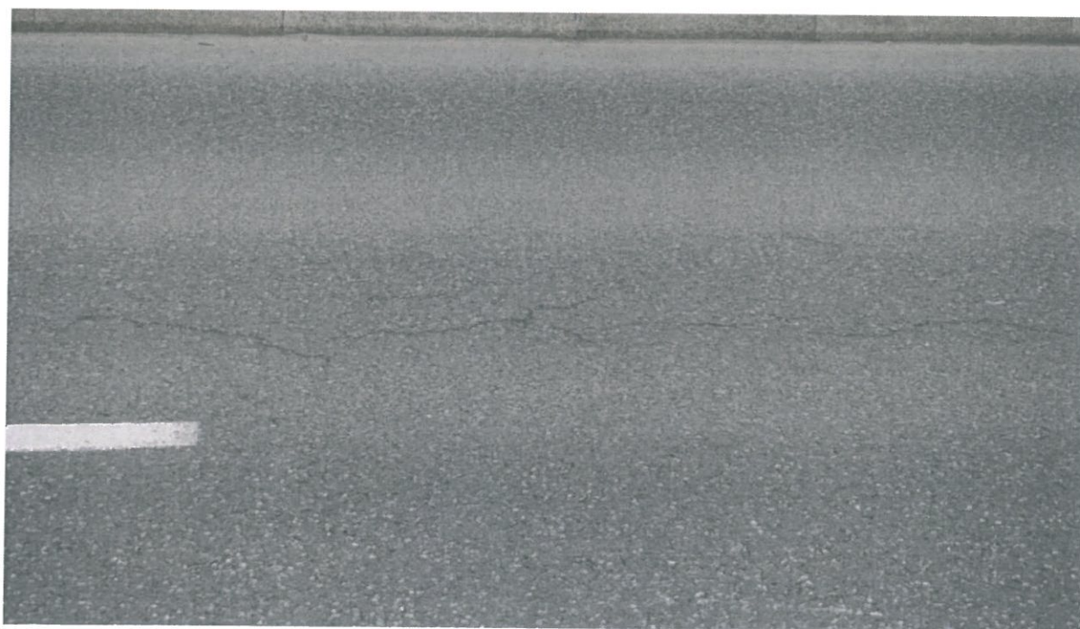
Fot. 86. Widoczne spękania oraz ubytki nawierzchni asfaltowej w przęśle pomiędzy podporami P11-P12 estakady zachodniej spowodowane najprawdopodobniej intensywną eksploatacją i słabą jakością mieszanki asfaltowej.
