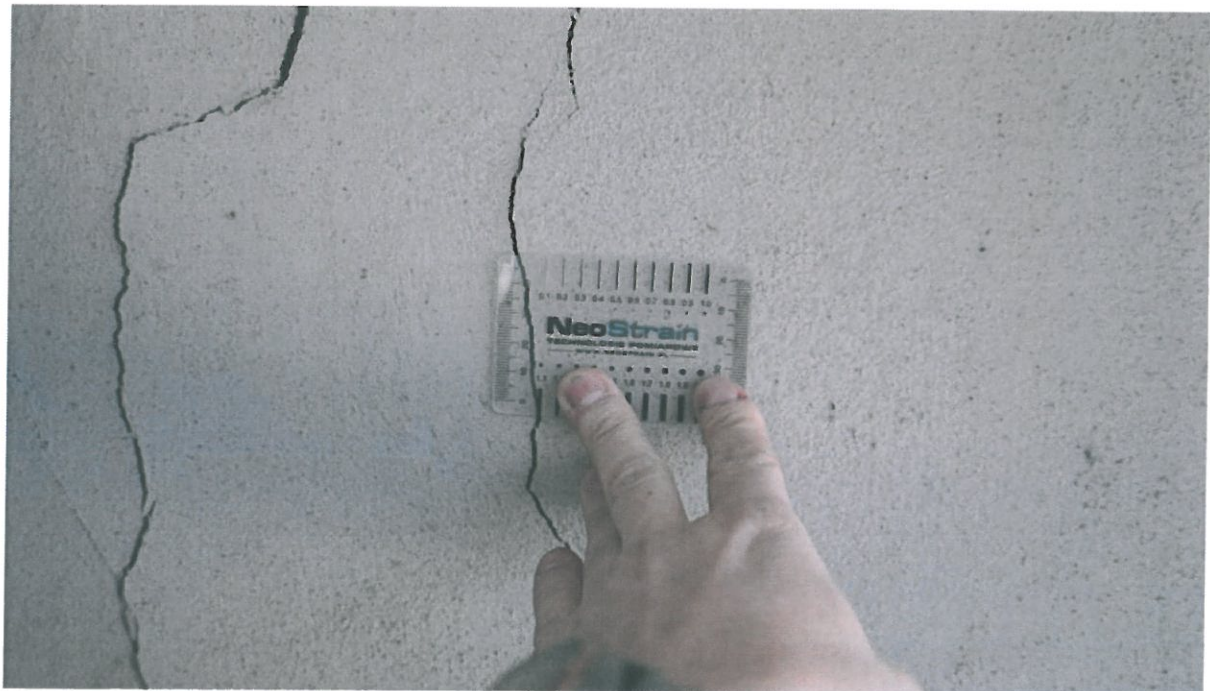
Fot. 28. Szczegół uszkodzenia jw.
