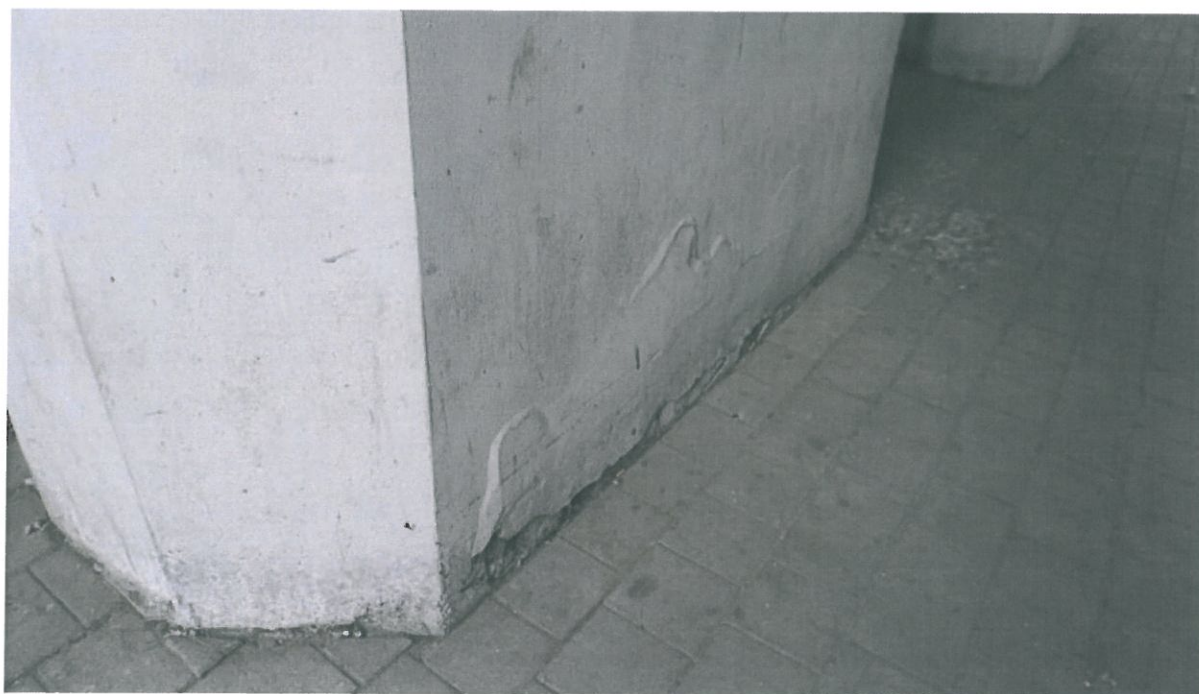
Fot. 144. Widoczne odspojenia, ubytki, spękania na podporze 3 estakady zachodniej spowodowane korozją prętów zbrojeniowych.
