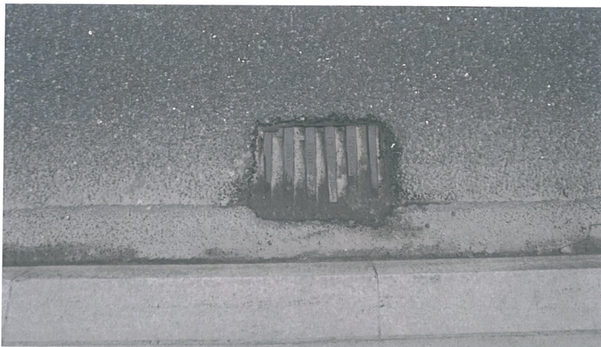
Fot. 22. Widoczna całkowita niedrożność systemu odwodnienia na estakadzie wschodniej w strefie podpory 14 spowodowane brakiem robót utrzymaniowo-porządkowych, 80% studzienek na obiekcie całkowicie niedrożnych.
