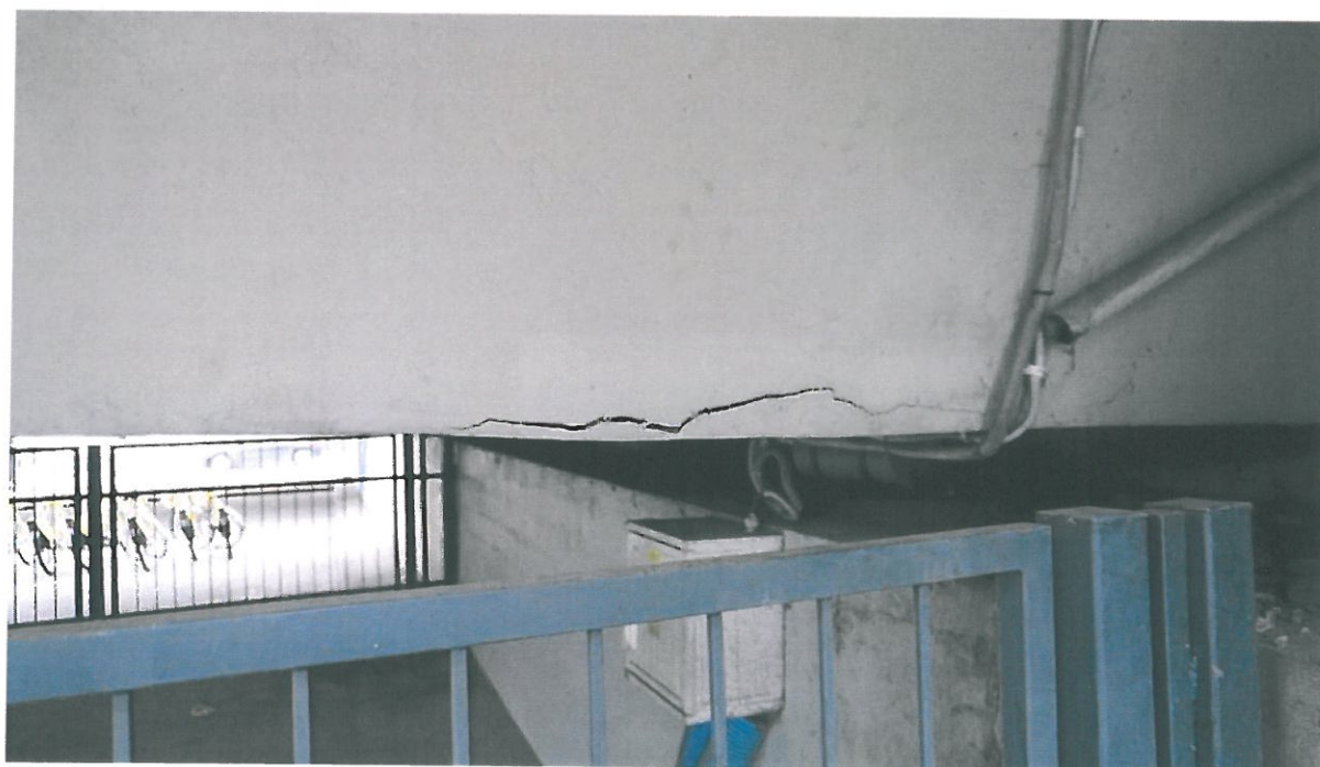
Fot. 136. Widoczne spękania powierzchni bocznej, zewnętrznej ustroju nośnego w przęśle skrajnym od strony Katowic spowodowane korozją prętów zbrojeniowych.
