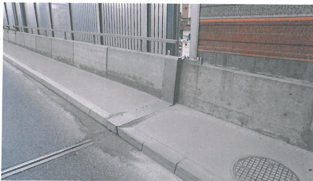
Fot. 24. Widoczne duże zanieczyszczenie wkładki dylatacyjnej na estakadzie wschodniej od strony Katowic spowodowane brakiem robót utrzymaniowo-porządkowych.
