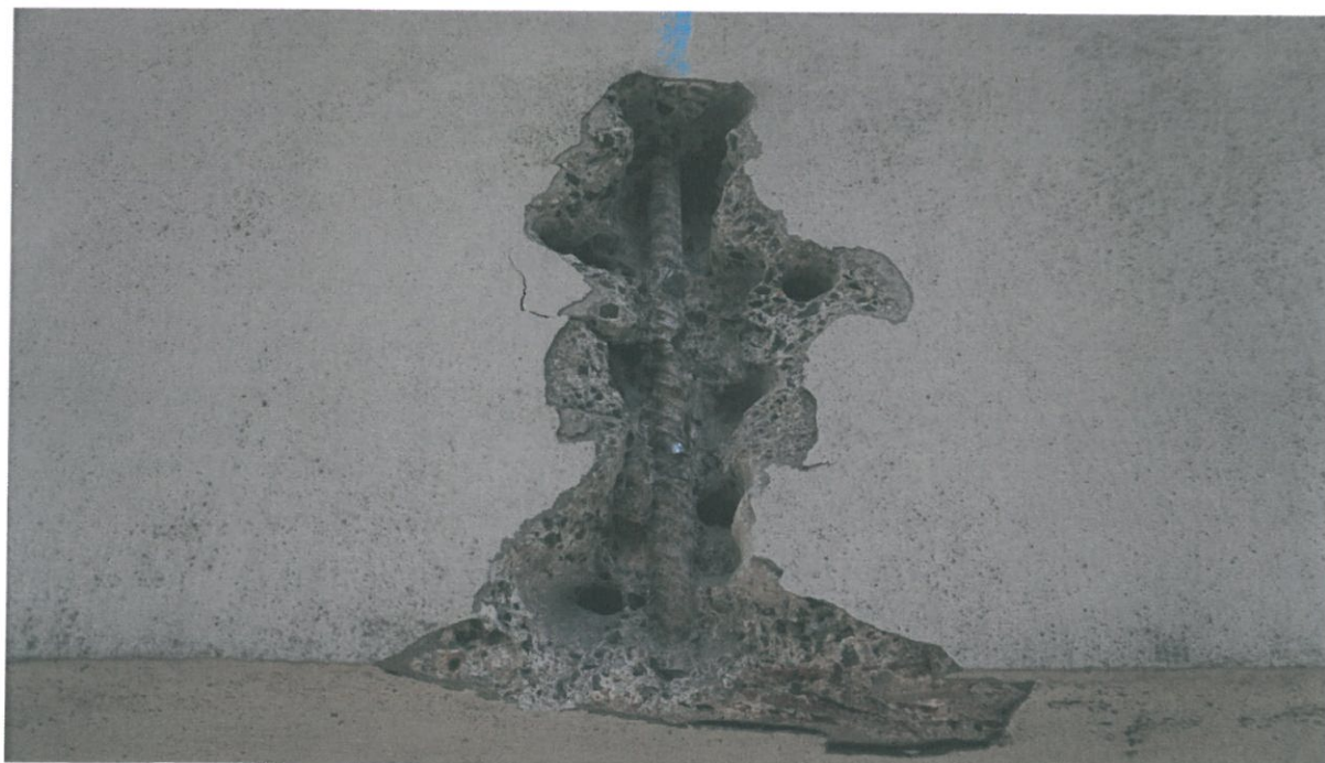
Fot. 154. Odkrywka nr I – Po odkuciu warstwy otuliny odsłonięto pręt zbrojeniowy z widocznymi śladami rozpoczętych procesów korozyjnych.
