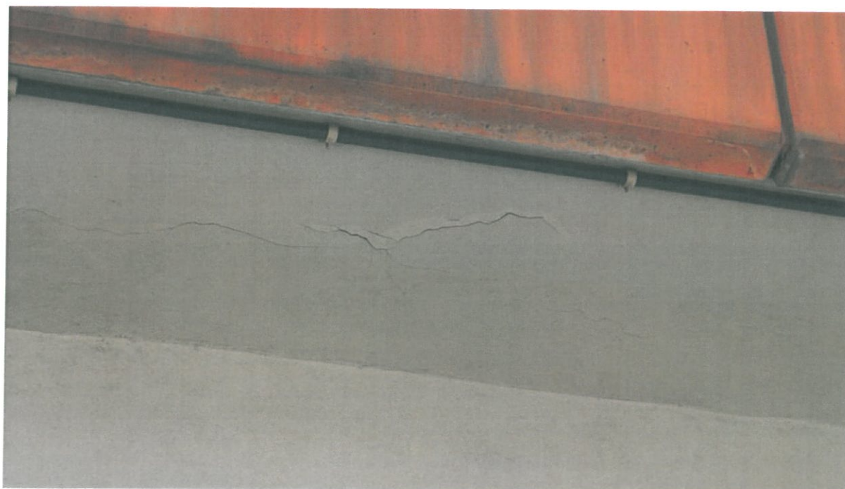
Fot. 36. Widoczne spękania dolnej, zewnętrznej powierzchni wspornika ustroju nośnego w przęśle pomiędzy podporami P10-P11 estakady wschodniej spowodowane korozją prętów zbrojeniowych.
