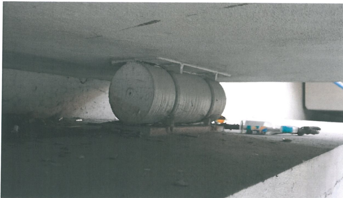
Fot. 73. Widoczne ogniska korozyjne na łożysku wałkowym stalowym zamontowanym na przyczółku od strony Katowic spowodowane niewłaściwym wykonaniem lub dobranym systemem zabezpieczenia antykorozyjnego.
