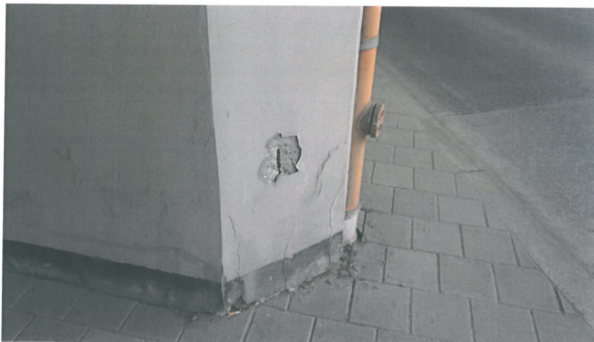
Fot. 79. Widoczne odspojenia, ubytki, spękania na podporze 3 estakady wschodniej spowodowane korozją prętów zbrojeniowych.
