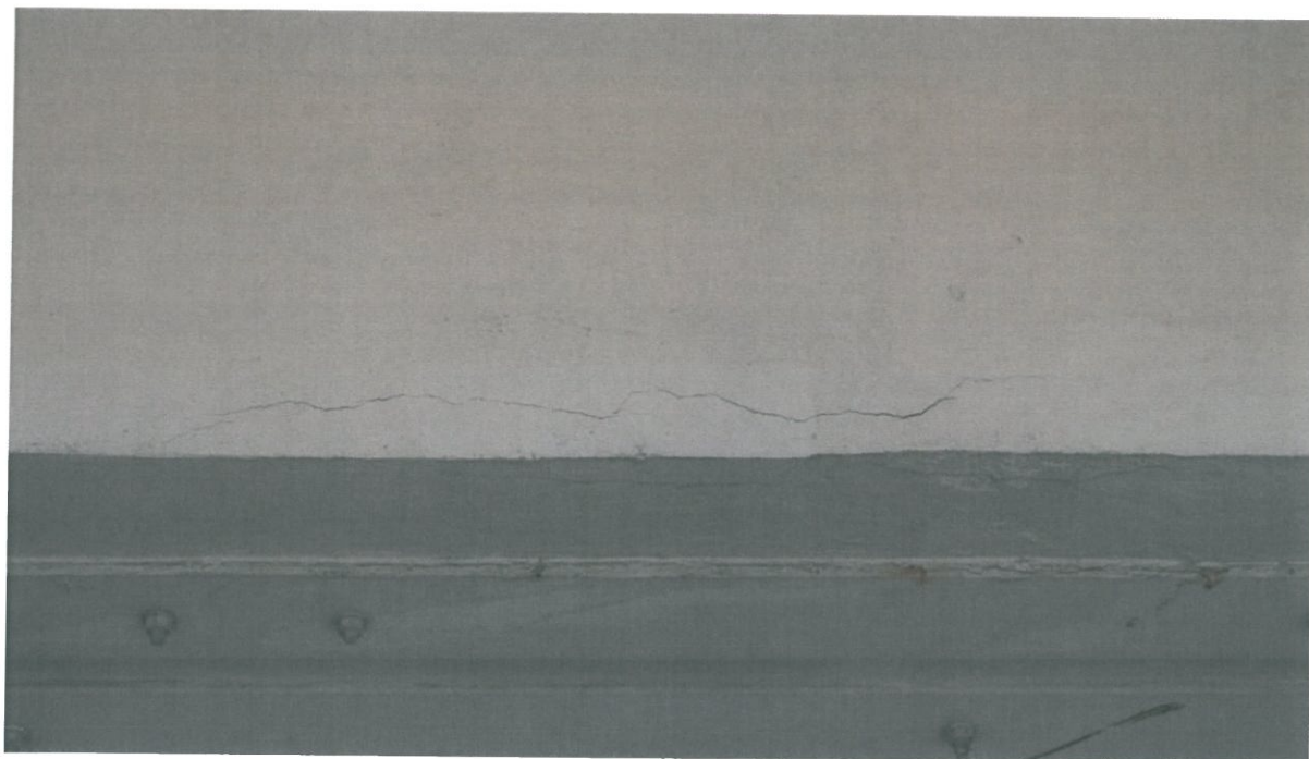
Fot. 101. Widoczne spękania powierzchni bocznej, wewnętrznej ustroju nośnego w przęśle pomiędzy podporami P12-P13 estakady zachodniej spowodowane korozją prętów zbrojeniowych. Dodatkowo widoczna korozja stalowych elementów wzmacniających spowodowane niedbałym wykonaniem powłoki ochronnej.
