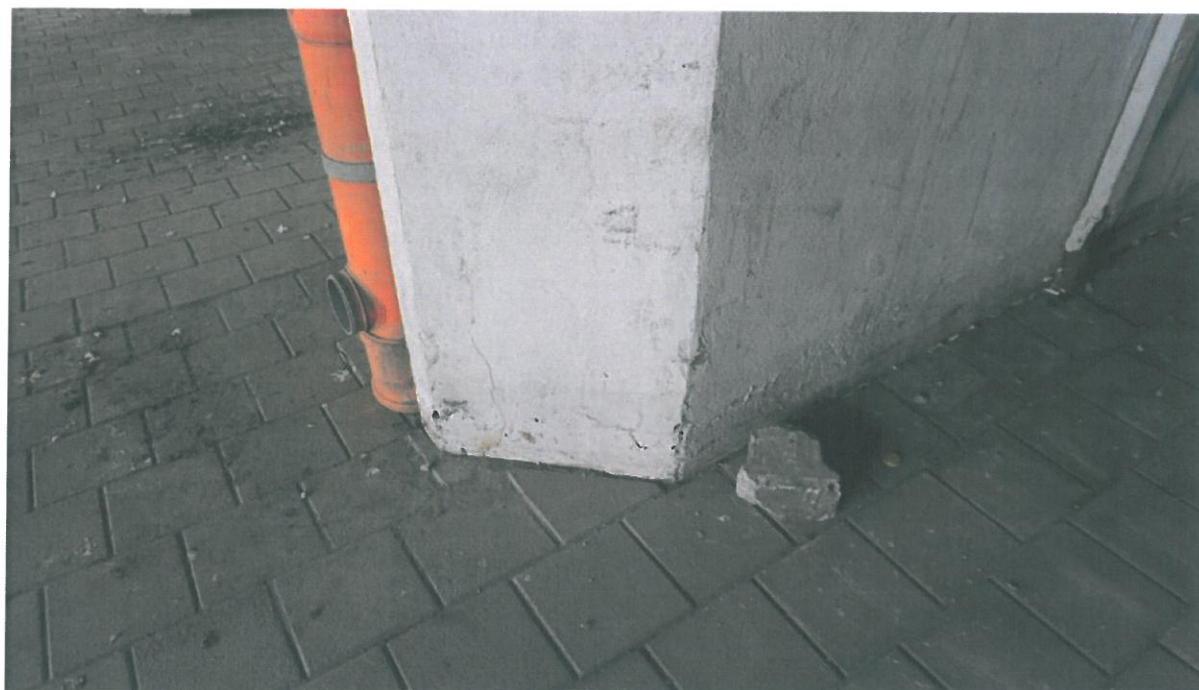
Fot. 145. Widoczne spękania na podporze 4 estakady zachodniej patrząc w kierunku Katowic spowodowane korozją prętów zbrojeniowych.
