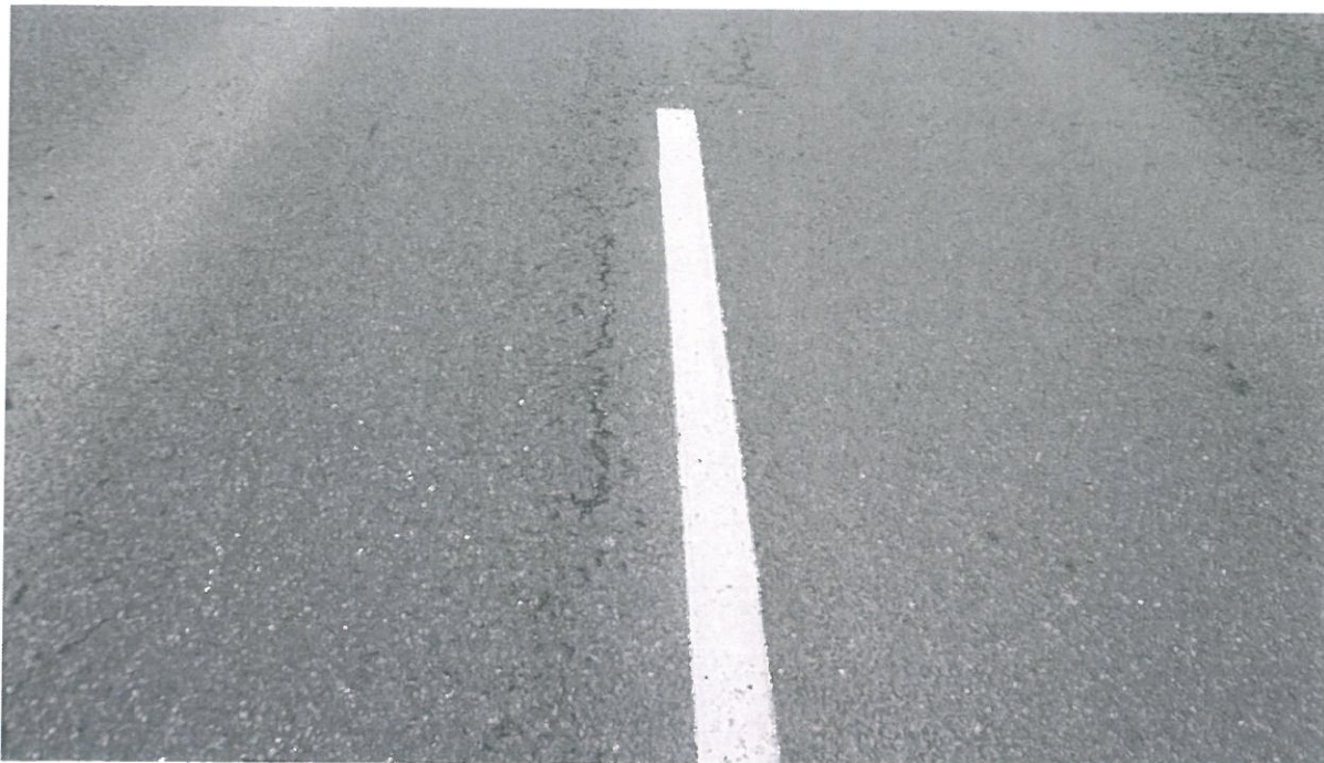
Fot. 21. Widoczne spękania nawierzchni asfaltowej w przęśle pomiędzy podporami P12-P13 estakady wschodniej spowodowane najprawdopodobniej intensywną eksploatacją i słabą jakością mieszanki asfaltowej.
