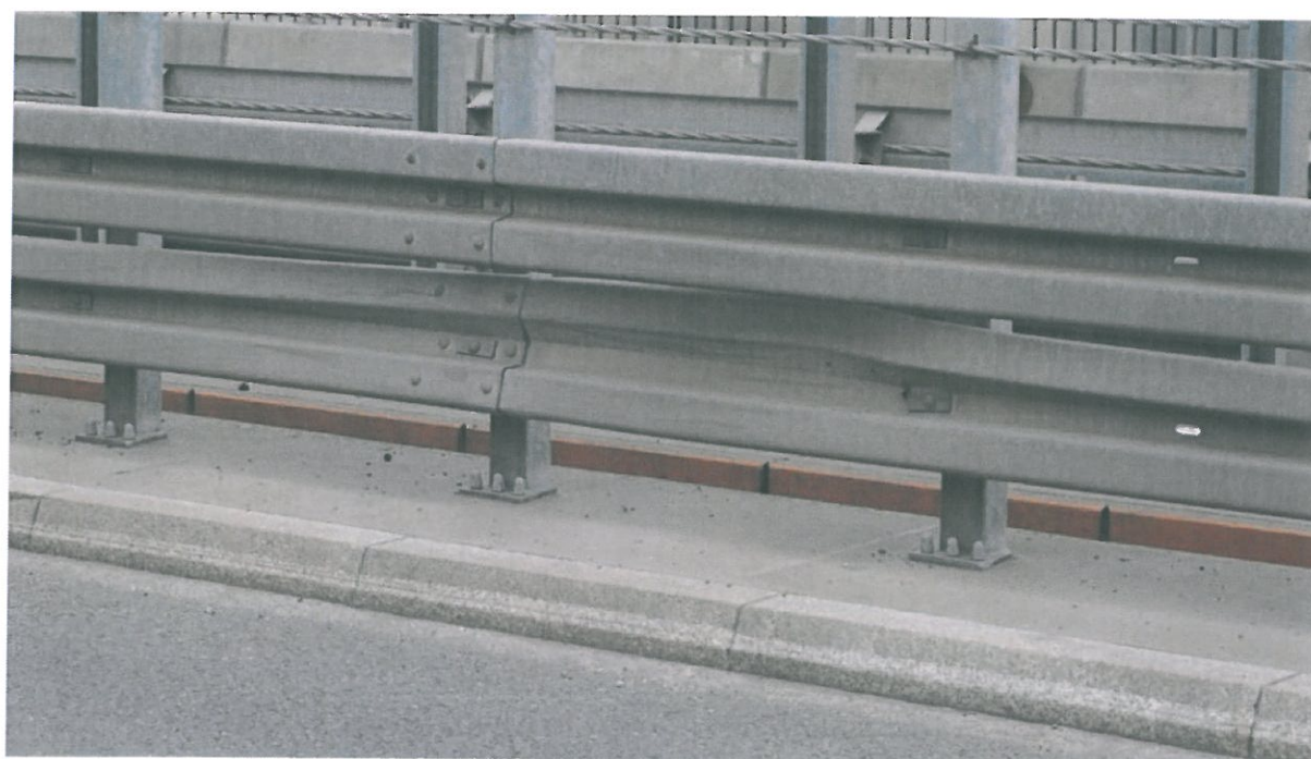
Fot. 140. Widoczna miejscowa deformacja bariery w przęśle pomiędzy podporami P4-P5 od strony wewnętrznej estakady zachodniej spowodowana uderzeniem mechanicznym.
