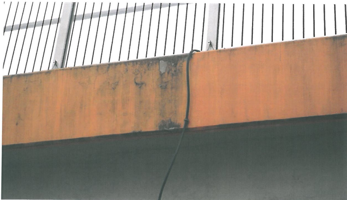
Fot. 137. Widoczne złuszczenia bocznej powierzchni deski gzymsowej w przęśle skrajnym od strony Bytomia na estakadzie zachodniej spowodowane słabą jakością materiału.
