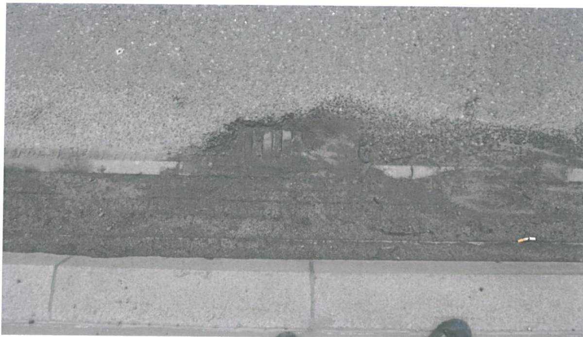
Fot. 89. Widoczna całkowita niedrożność systemu odwodnienia na estakadzie zachodniej w strefie podpory 3 spowodowane brakiem robót utrzymaniowo-porządkowych.
