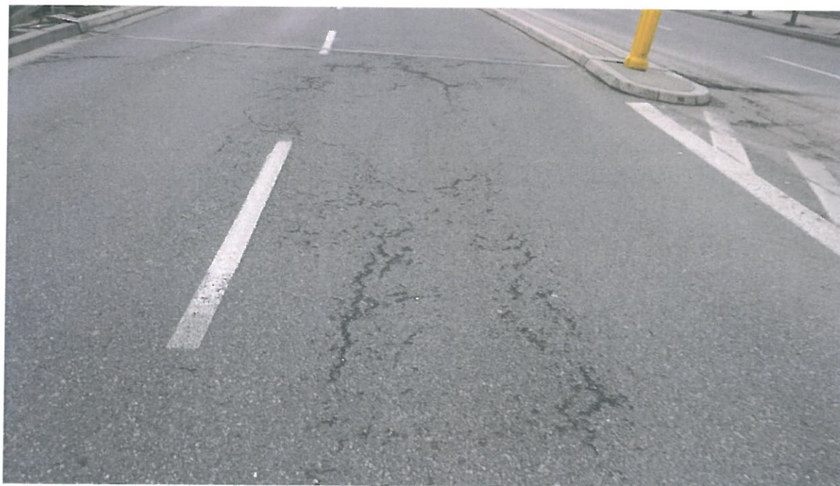
Fot. 20. Widoczne spękania nawierzchni asfaltowej na dojeździe do estakady wschodniej od strony Bytomia spowodowane najprawdopodobniej intensywną eksploatacją i słabą jakością mieszanki asfaltowej.
