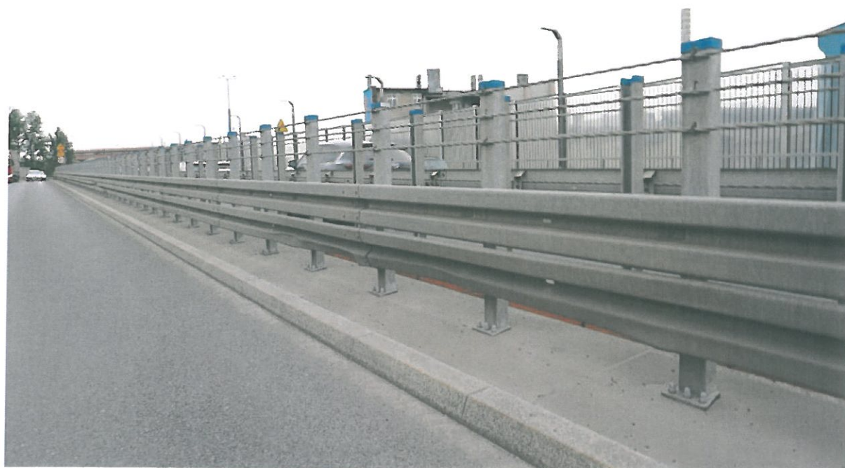
Fot. 139. Widoczna miejscowa deformacja bariery w przęśle pomiędzy podporami P6-P7 od strony wewnętrznej estakady zachodniej spowodowana uderzeniem mechanicznym.
