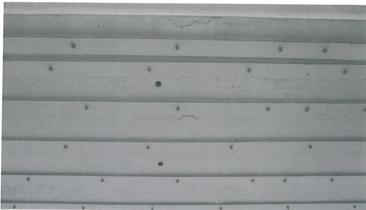
Fot. 69. Widoczne odspojenia oraz spękania powierzchni dolnej ustroju nośnego w przęśle pomiędzy podporami P12-P13 estakady wschodniej spowodowane korozją prętów zbrojeniowych.
