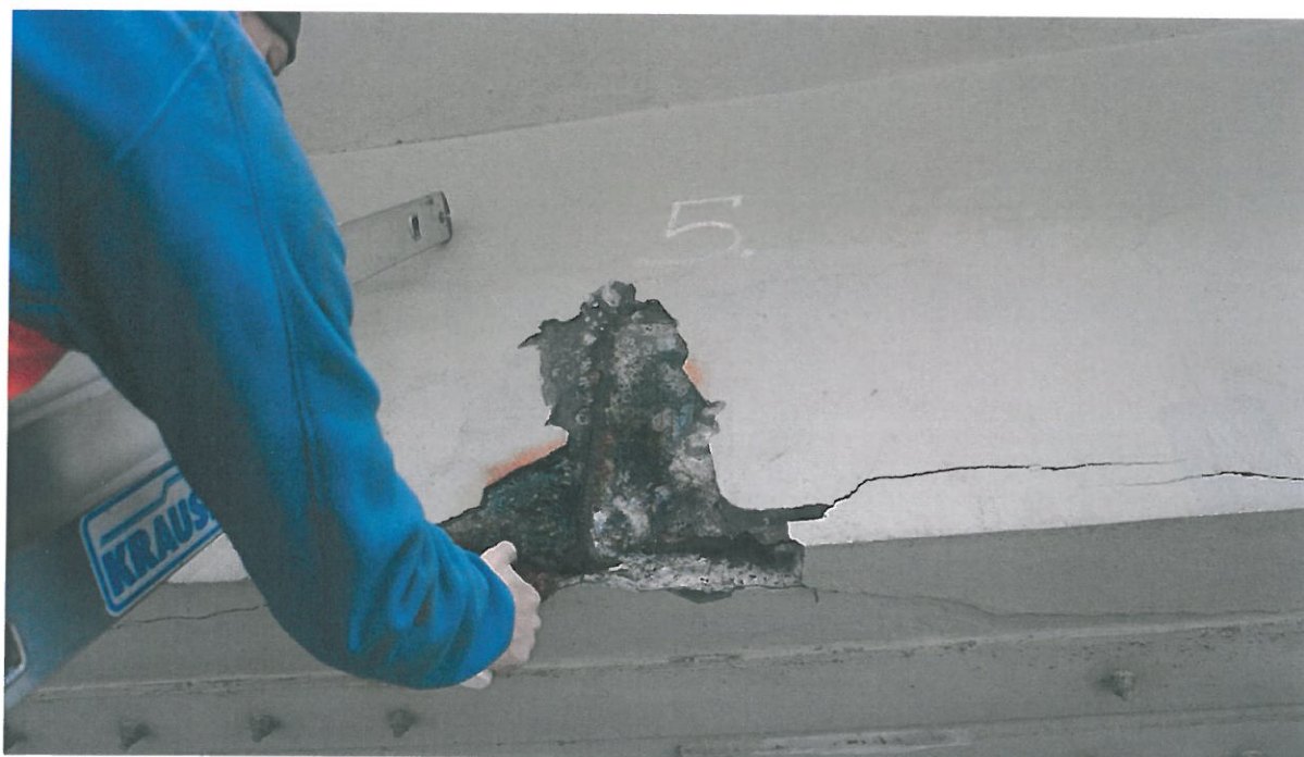
Fot. 153. Odkrywka nr 5 w prześle P13-P14 estakady wschodniej – Usunięcie otuliny odsłania mocno skorodowane pręty zbrojeniowe.
