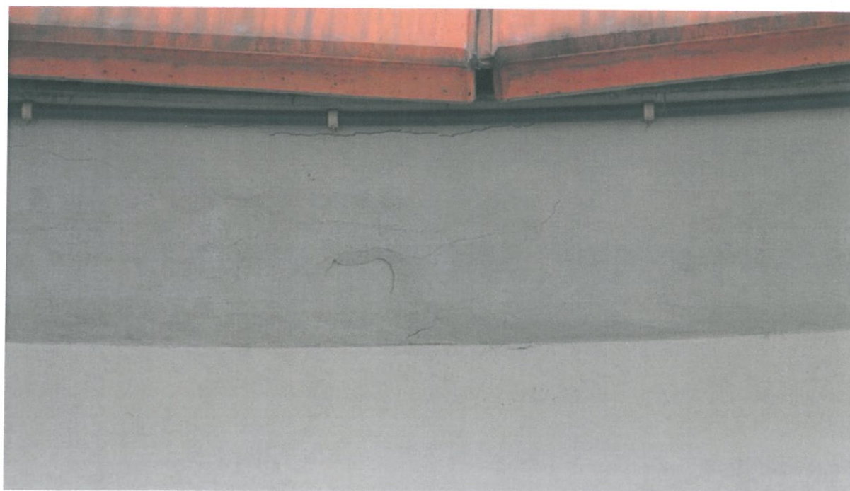
Fot. 44. Widoczne odspojenia oraz spękania dolnej powierzchni wspornika ustroju nośnego pomiędzy podporami P2-P3 estakady wschodniej spowodowane korozją prętów zbrojeniowych.
