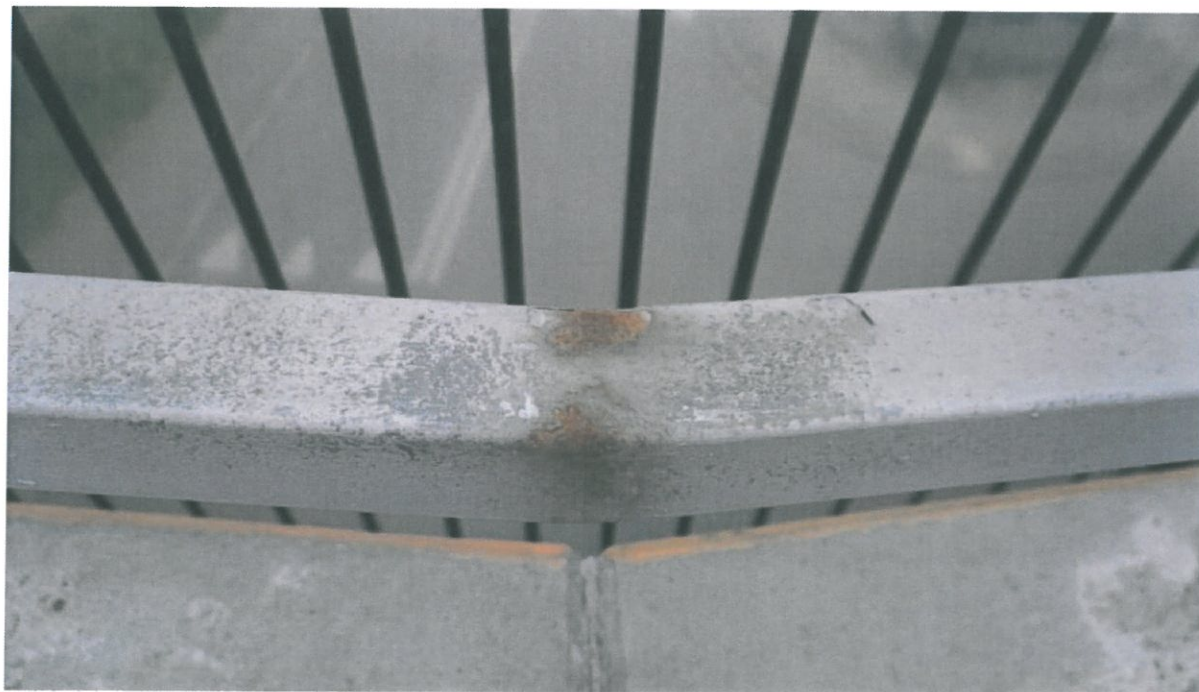
Fot. 74. Widoczne ogniska korozyjne na pochwycie stalowym w przęśle pomiędzy podporami P2-P3 estakady wschodniej spowodowane najprawdopodobniej słabą jakością zabezpieczenia antykorozyjnego i stosowaniem środków odładowych w okresie zimowym.
