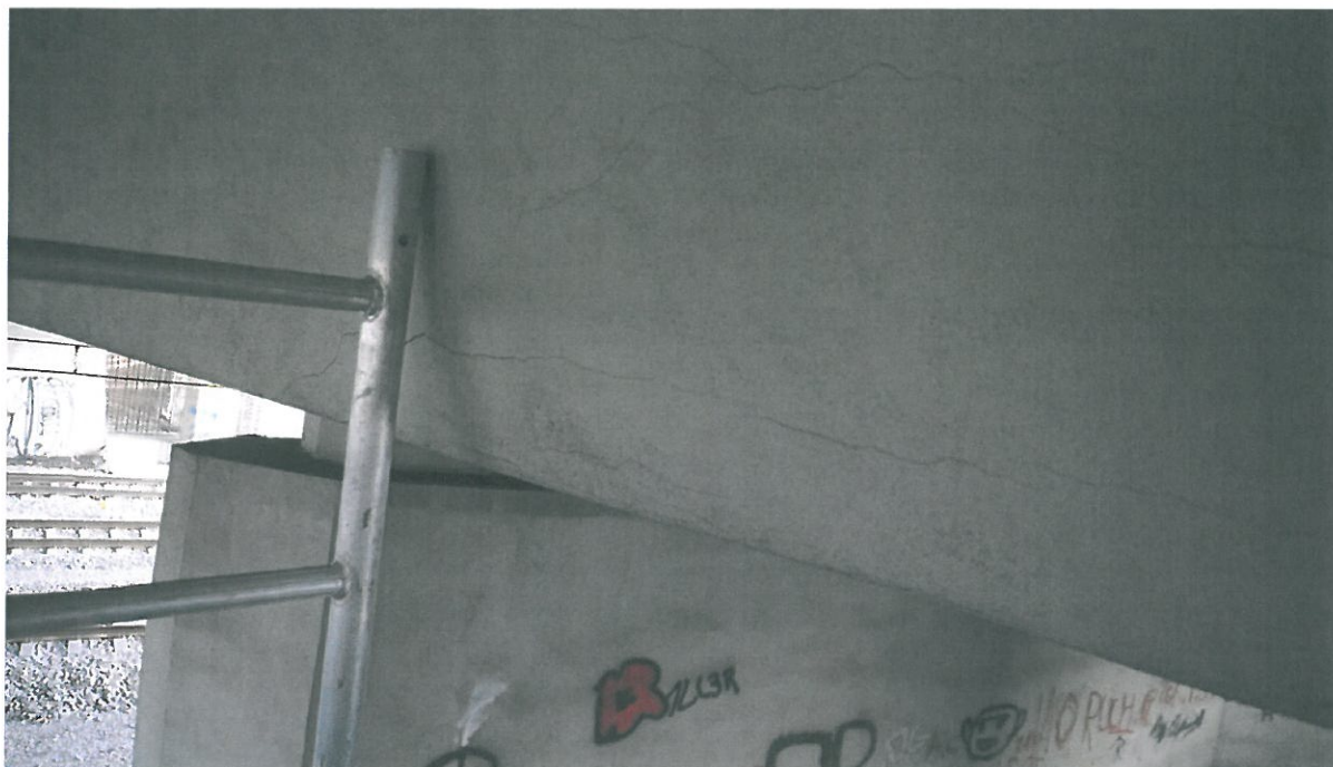
Fot. 146. Miejsce wyznaczone od odkrywki nr 1 na estakadzie wschodniej w prześle P2-P3 z widocznymi uszkodzeniami w postaci poziomach pęknięć na bocznej powierzchni ustroju nośnego.
