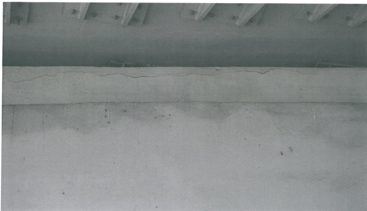
Fot. 143. Widoczne spękania poziome powierzchni czołowej przyczółka od strony Bytomia na estakadzie zachodniej spowodowane korozją prętów zbrojeniowych.
