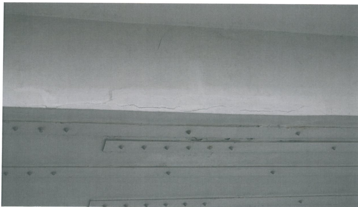
Fot. 128. Widoczne spękania oraz odspojenie powierzchni bocznej, dolnej, zewnętrznej ustroju nośnego w przęśle pomiędzy podporami P5-P6 estakady zachodniej spowodowane korozją prętów zbrojeniowych.
