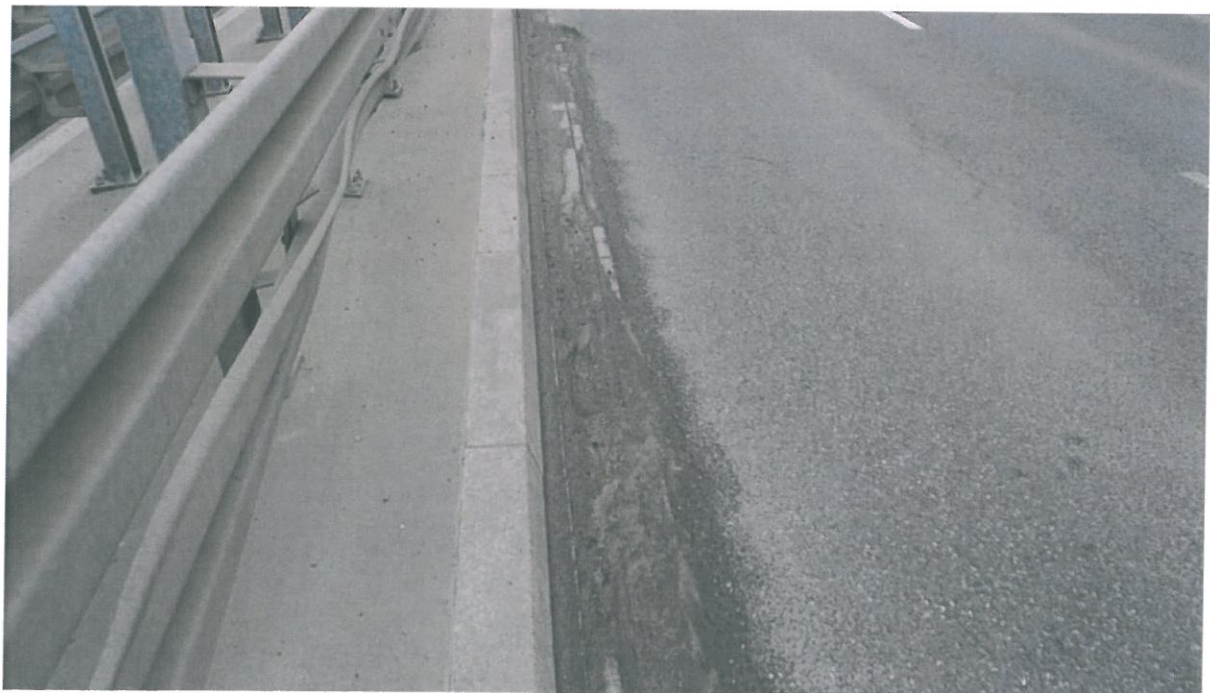
Fot. 88. Widoczna duże zanieczyszczenie elementów kamienny odwodnienia na estakadzie zachodniej od strony wewnętrznej w strefie krawężnika – prześło pomiędzy podporami P2-P3. Zanieczyszczenia spowodowane brakiem robót utrzymaniowo-porządkowych.
