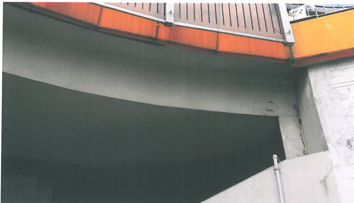
Fot. 45. Widoczne ubytki betonu oraz wykwity korozyjne na bocznej powierzchni ustroju nośnego pomiędzy podporami P2-P3 estakady wschodniej spowodowane korozją prętów zbrojeniowych i najprawdopodobniej brakiem szczelnej izolacji lub dylatacji.
