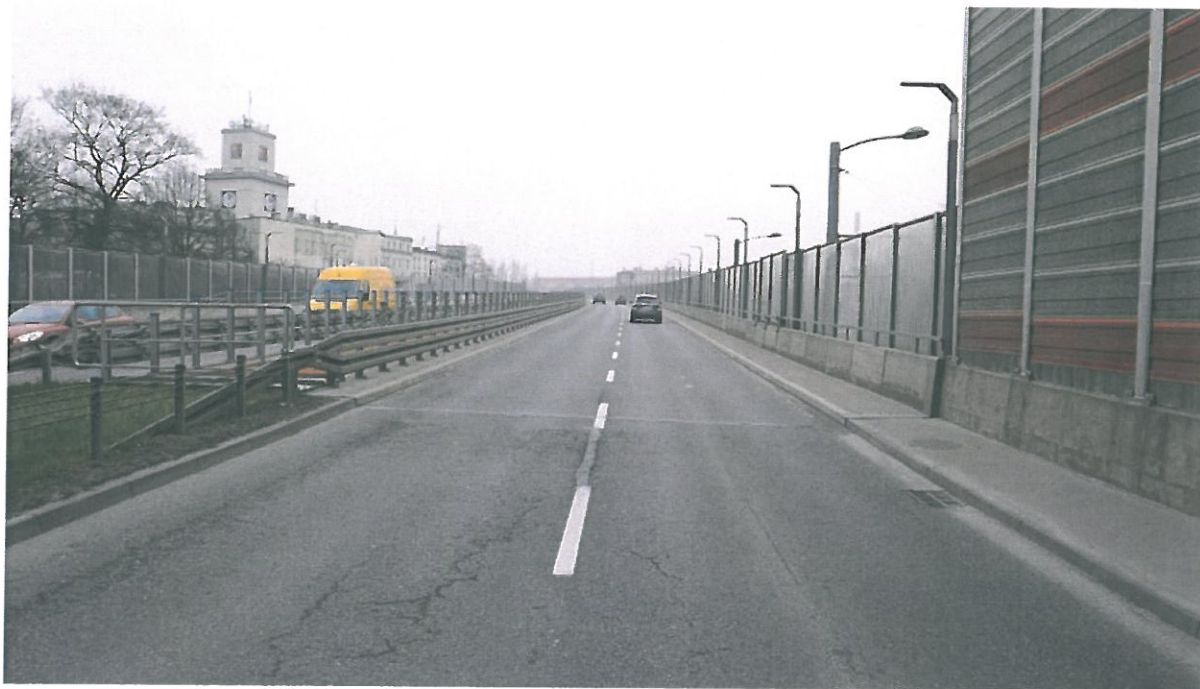
Fot. 19. Widoczne spękania nawierzchni asfaltowej na dojeździe do estakady wschodniej od strony Katowic spowodowane najprawdopodobniej intensywną eksploatacją i słabą jakością mieszanki asfaltowej.
