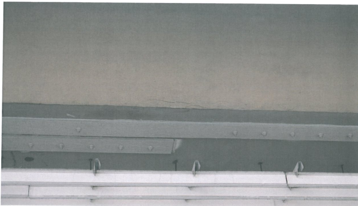
Fot. 103. Widoczne spękania powierzchni bocznej, wewnętrznej ustroju nośnego w przęśle pomiędzy podporami P10-P11 estakady zachodniej spowodowane korozją prętów zbrojeniowych.
