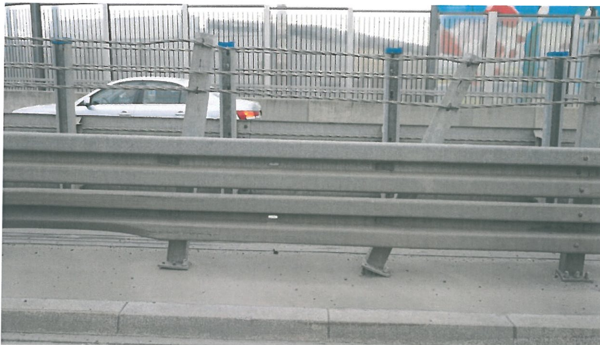
Fot. 141. Widoczna miejscowa deformacja bariery w prześle pomiędzy podporami P4-P5 od strony wewnętrznej estakady zachodniej spowodowana uderzeniem mechanicznym.
