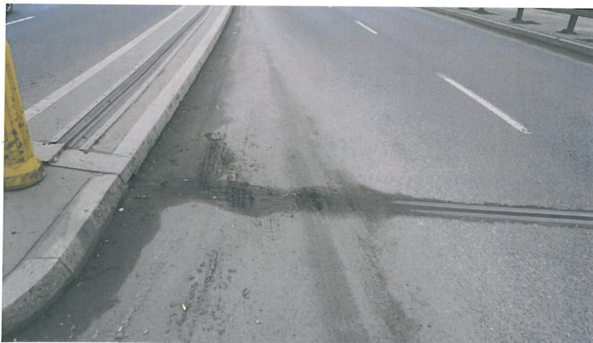
Fot. 94. Widoczne duże zanieczyszczenie wkładki dylatacyjnej na estakadzie zachodniej od strony Bytomia spowodowane brakiem robót utrzymaniowo-porządkowych.
