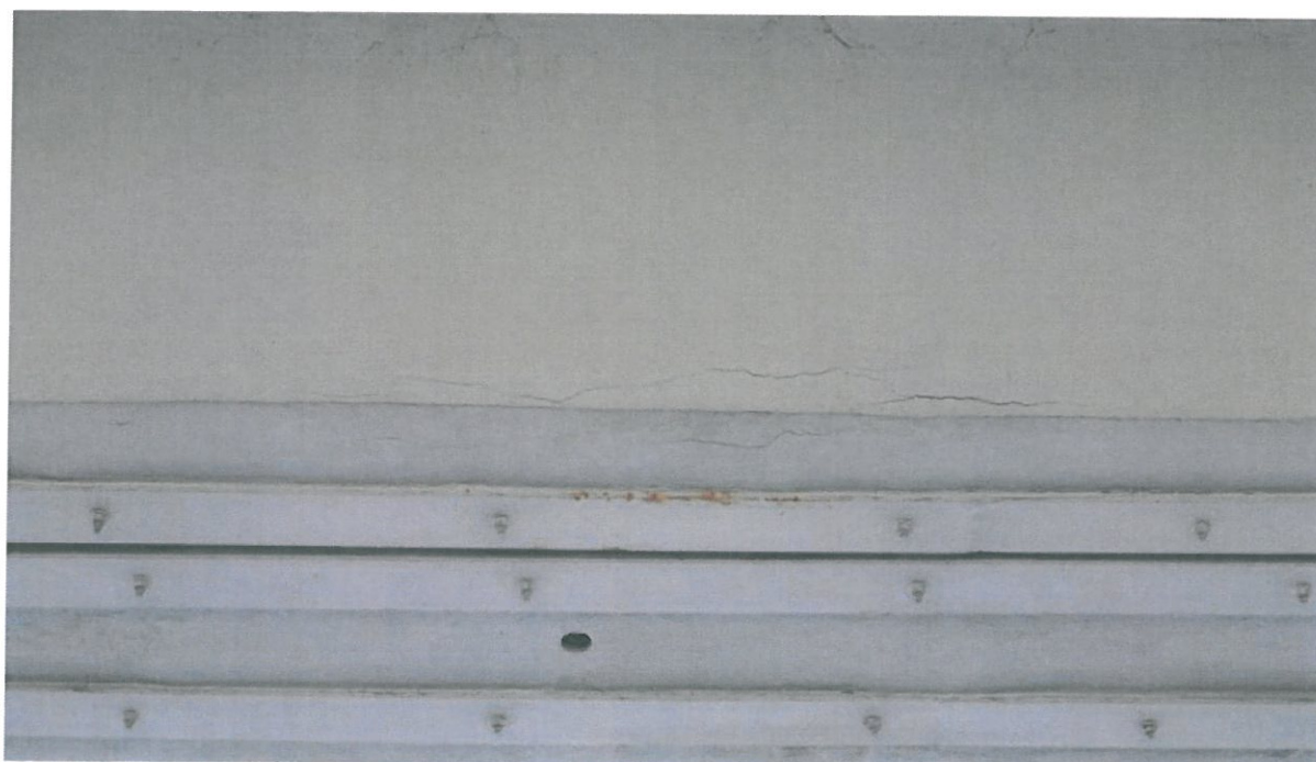
Fot. 52. Widoczne spękania powierzchni bocznej, dolnej, wewnętrznej ustroju nośnego w przęśle pomiędzy podporami P4-P5 estakady wschodniej spowodowane korozją prętów zbrojeniowych. Dodatkowo widoczna korozja stalowych elementów wzmacniających spowodowane niedbałym wykonaniem powłoki ochronnej.
