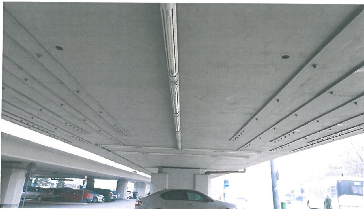
Fot. 6. Widok ogólny spodu konstrukcji estakady wschodniej między podporami P13, P14. Na spodzie ustroju nośnego widoczne stalowe elementy wzmacniające.
