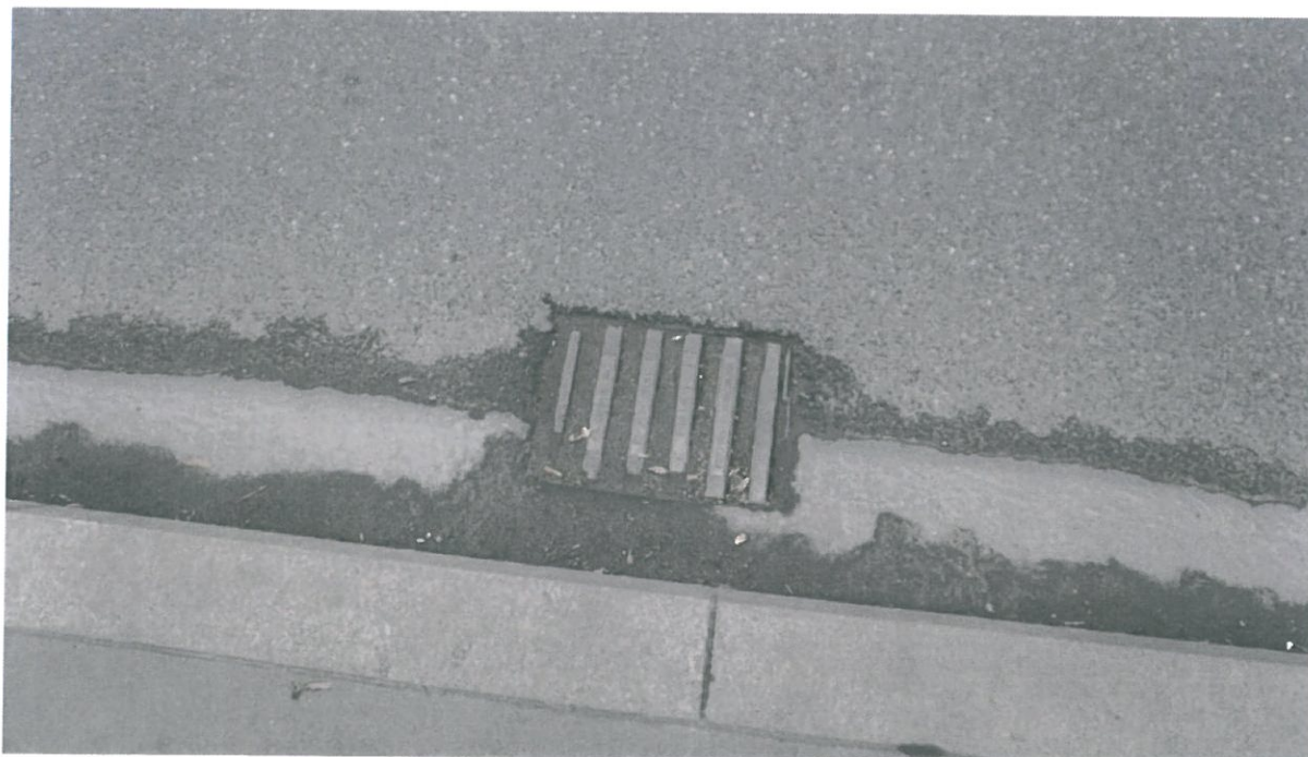
Fot. 92. Widoczna całkowita niedrożność systemu odwodnienia na estakadzie zachodniej w strefie podpory 14 spowodowane brakiem robót utrzymaniowo-porządkowych.
