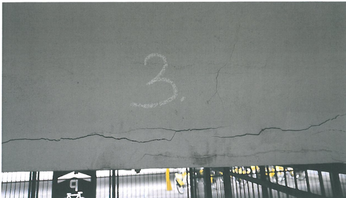
Fot. 150. Miejsce wyznaczone od odkrywki nr 3 na estakadzie zachodniej w prześle P14-PK z widocznymi uszkodzeniami w postaci poziomach pęknięć na bocznej powierzchni ustroju nośnego.
