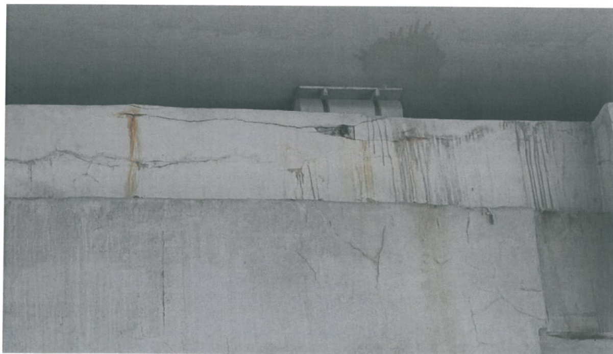
Fot. 78. Widoczne zacieki korozyjne oraz ubytki betonu i spękania poziome powierzchni czołowej przyczółka od strony Bytomia na estakadzie wschodniej spowodowane korozją prętów zbrojeniowych.
