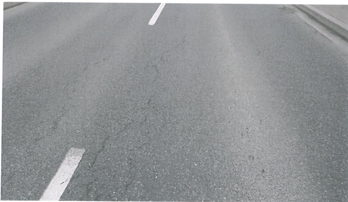
Fot. 84. Widoczne spękania nawierzchni asfaltowej w przęśle pomiędzy podporami P8-P9 estakady zachodniej spowodowane najprawdopodobniej intensywną eksploatacją i słabą jakością mieszanki asfaltowej.
