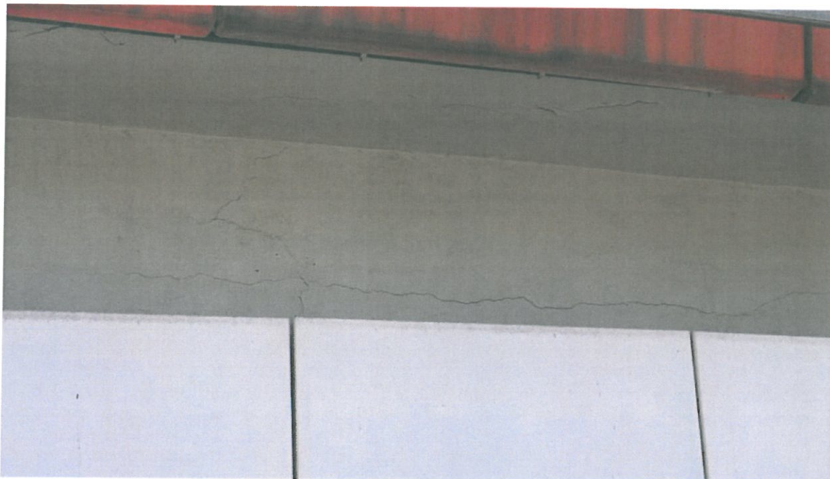
Fot. 35. Widoczne spękania powierzchni bocznej, zewnętrznej ustroju nośnego w przęśle pomiędzy podporami P10-P11 estakady wschodniej spowodowane korozją prętów zbrojeniowych.
