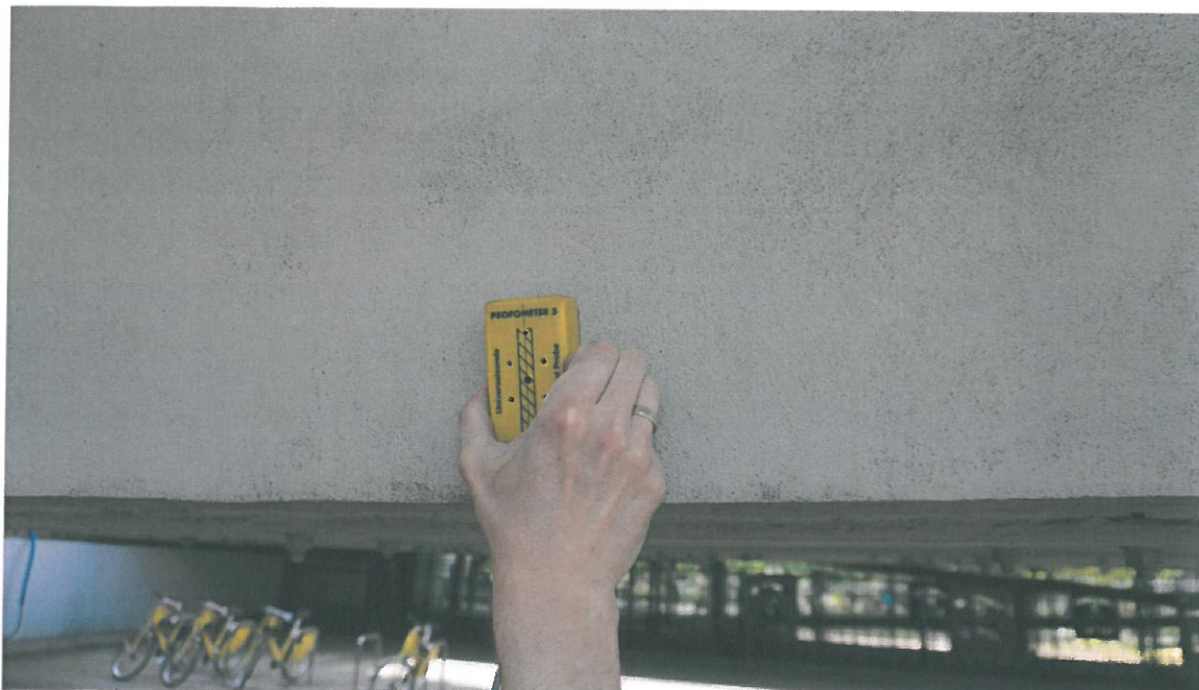
Fot. 153. Miejsce wyznaczone od odkrywki nr I na estakadzie wschodniej gdzie nie występują widoczne uszkodzenia. Dokładną lokalizację zbrojenia wyznaczono za pomocą profometru.
