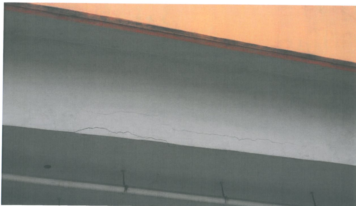
Fot. 123. Widoczne spękania powierzchni bocznej, zewnętrznej ustroju nośnego w przęśle pomiędzy podporami P2-P3 estakady zachodniej spowodowane korozją prętów zbrojeniowych.
