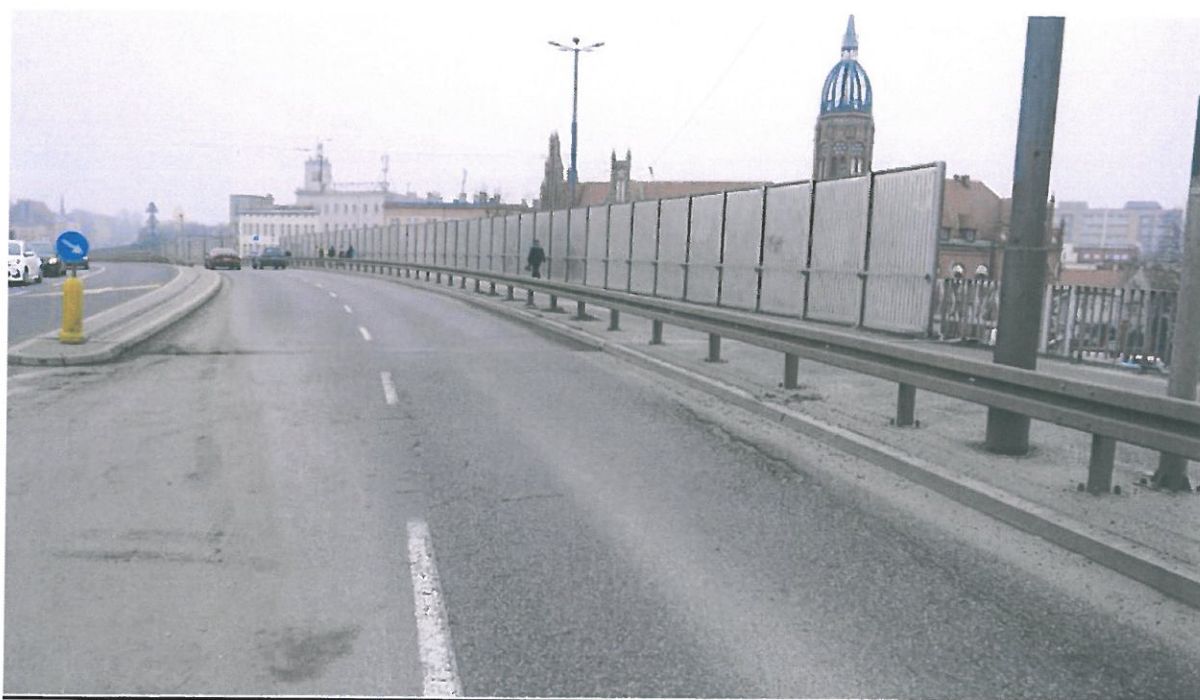
Fot. 80. Widoczne spękania oraz ubytki nawierzchni asfaltowej na dojeździe do estakady zachodniej od strony Bytomia spowodowane najprawdopodobniej intensywną eksploatacją i słabą jakością mieszanki asfaltowej.
