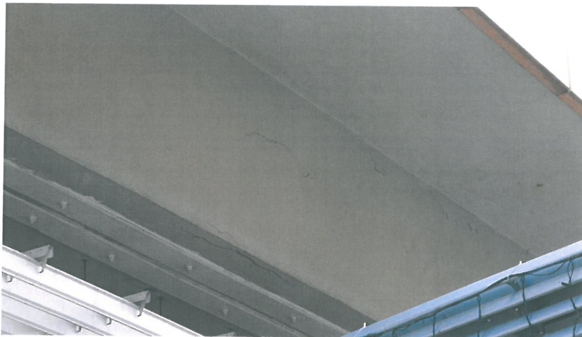
Fot. 57. Widoczne spękania powierzchni bocznej, dolnej, wewnętrznej ustroju nośnego w przęśle pomiędzy podporami P10-P11 estakady wschodniej spowodowane korozją prętów zbrojeniowych.
