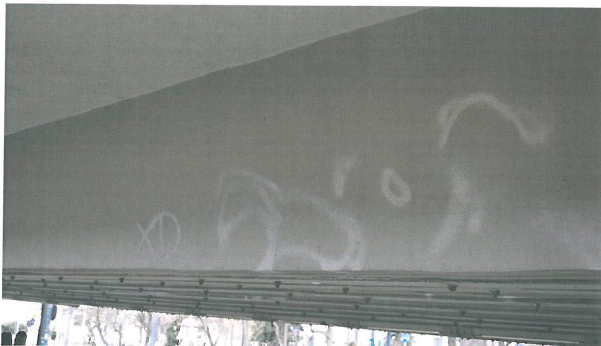
Fot. 67. Widoczne zanieczyszczenie w postaci graffiti powierzchni bocznej ustroju nośnego w przęśle skrajnym od strony Katowic na estakadzie wschodniej spowodowane celowym aktem wandalizmu.
