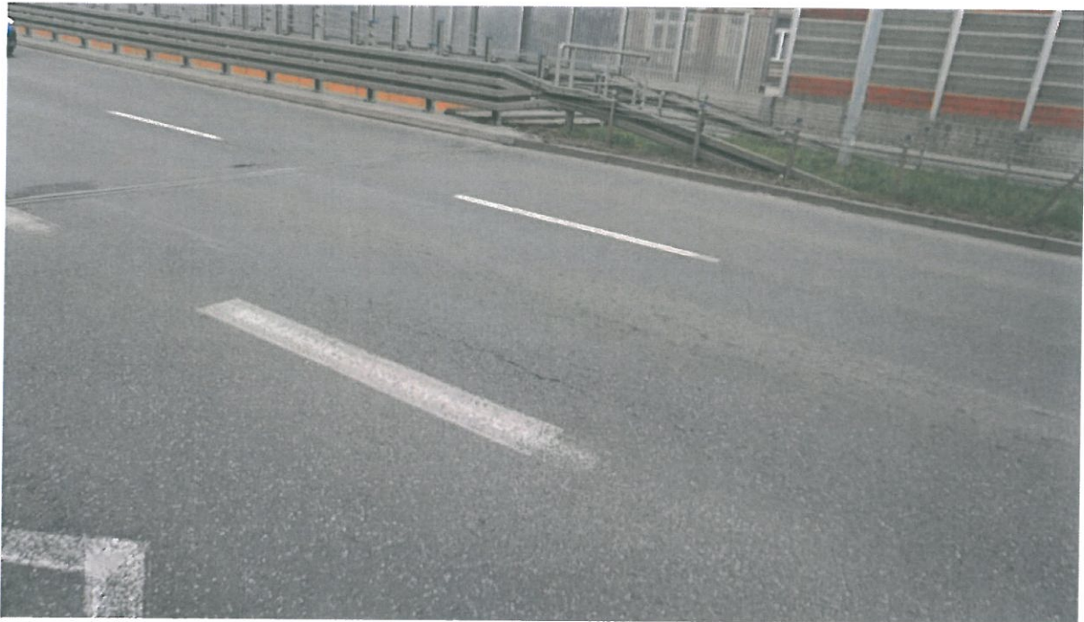
Fot. 81. Widoczne spękania nawierzchni asfaltowej na dojeździe do estakady zachodniej od strony Katowic spowodowane najprawdopodobniej intensywną eksploatacją i słabą jakością mieszanki asfaltowej.
