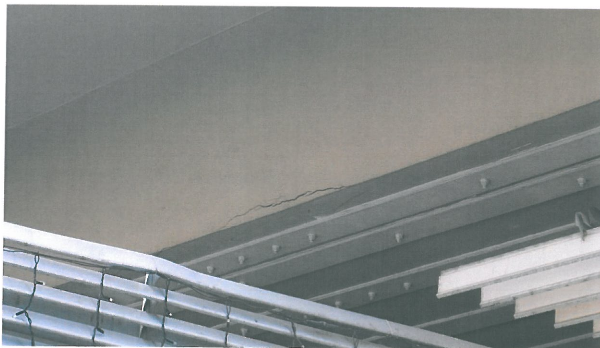
Fot. 104. Widoczne spękania powierzchni bocznej, wewnętrznej ustroju nośnego w przęśle pomiędzy podporami P8-P9 estakady zachodniej spowodowane korozją prętów zbrojeniowych.
