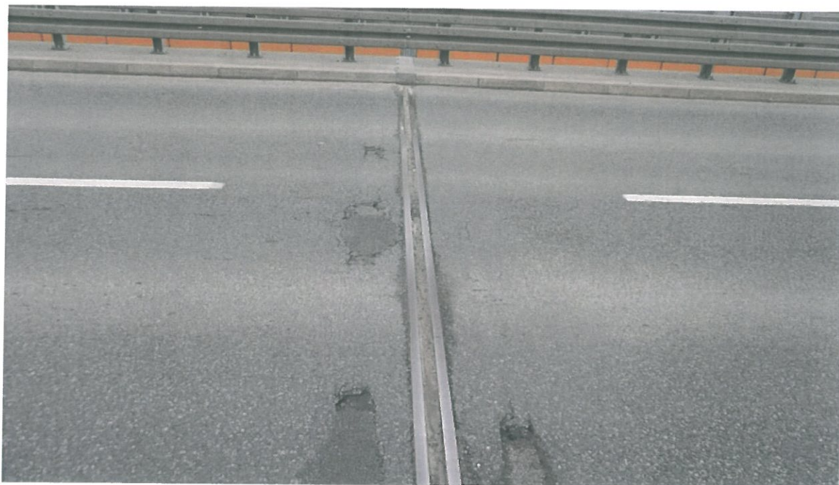
Fot. 85. Widoczne spękania oraz ubytki nawierzchni asfaltowej w przęśle pomiędzy podporami P9-P10 estakady zachodniej spowodowane najprawdopodobniej intensywną eksploatacją i słabą jakością mieszanki asfaltowej.
