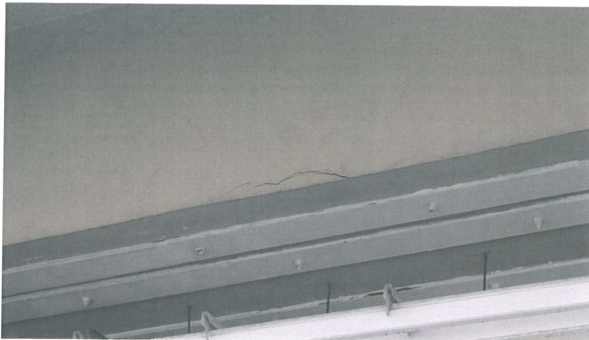
Fot. 105. Widoczne spękania powierzchni bocznej, wewnętrznej ustroju nośnego w przęśle pomiędzy podporami P8-P9 estakady zachodniej spowodowane korozją prętów zbrojeniowych.
