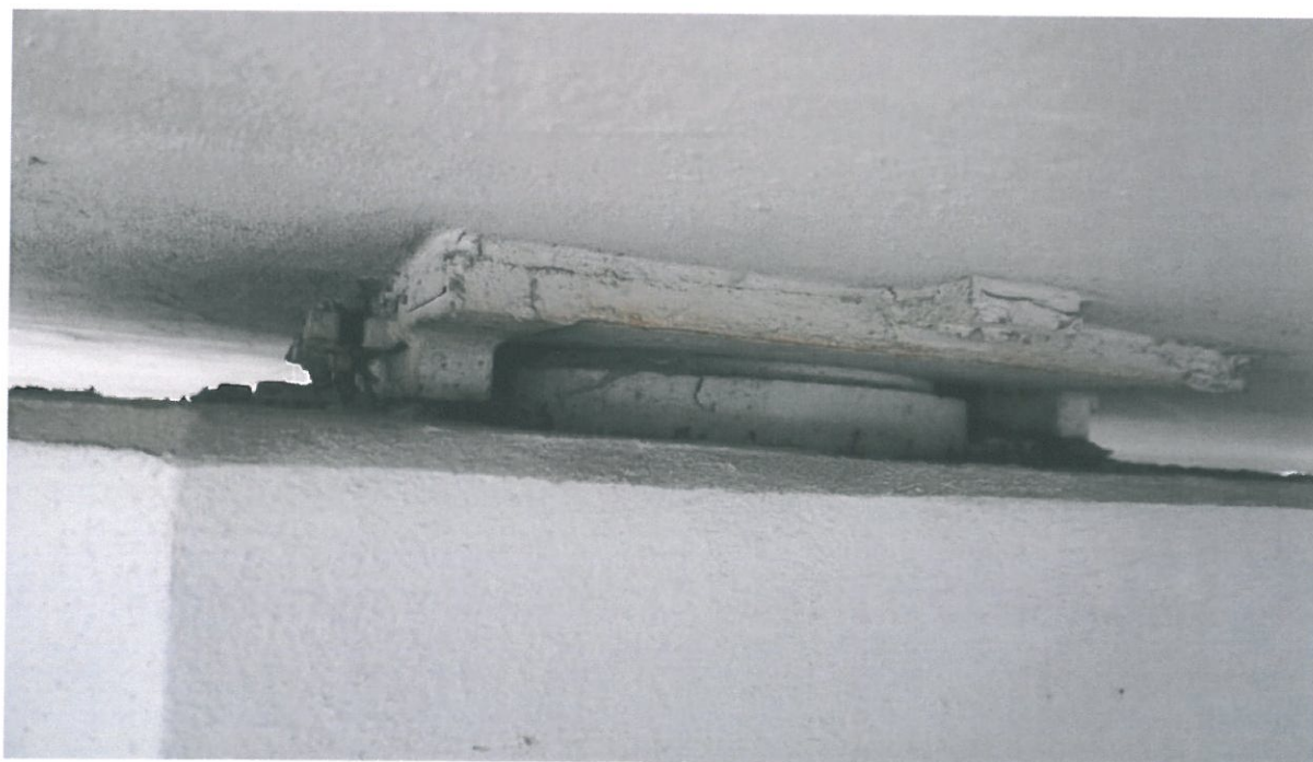
Fot. 72. Widoczne ogniska korozyjne na łożysku garnkowym stalowym jednokierunkowym na podporze 14 spowodowane niewłaściwym wykonaniem lub dobranym systemem zabezpieczenia antykorozyjnego.
