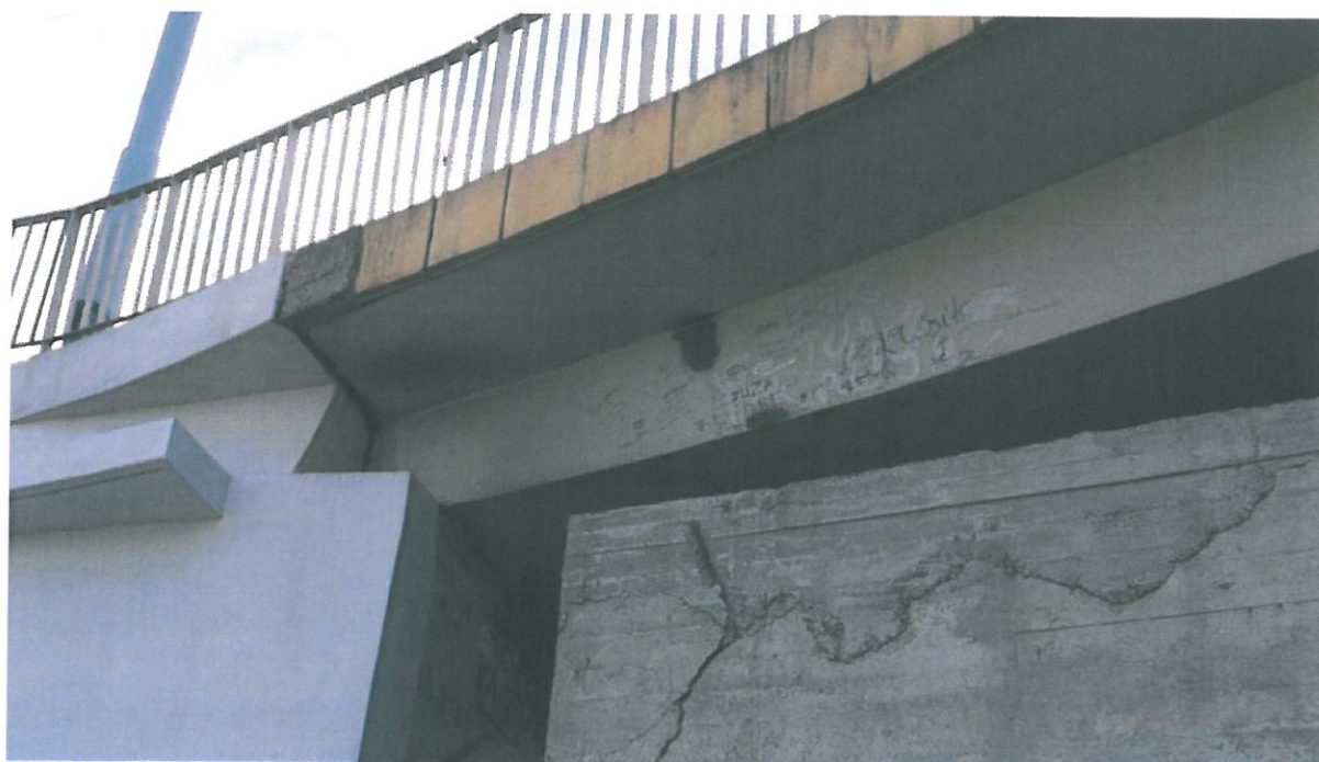
Fot. 46. Widoczne zanieczyszczenia w postaci graffiti na bocznej powierzchni ustroju nośnego w skrajnym przęśle od strony Bytomia na estakadzie wschodniej spowodowane celowym aktem wandalizmu.
