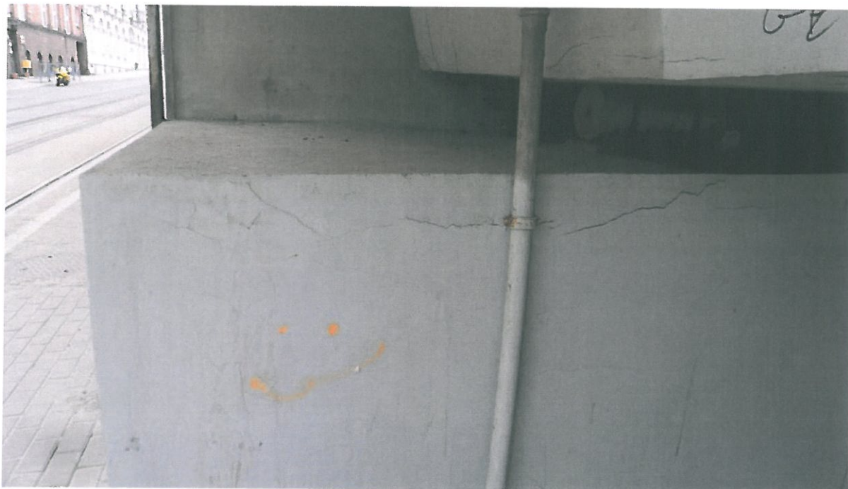
Fot. 75. Widoczne spękania powierzchni czołowej przyczółka od strony Katowic na estakadzie wschodniej spowodowane korozją prętów zbrojeniowych.
