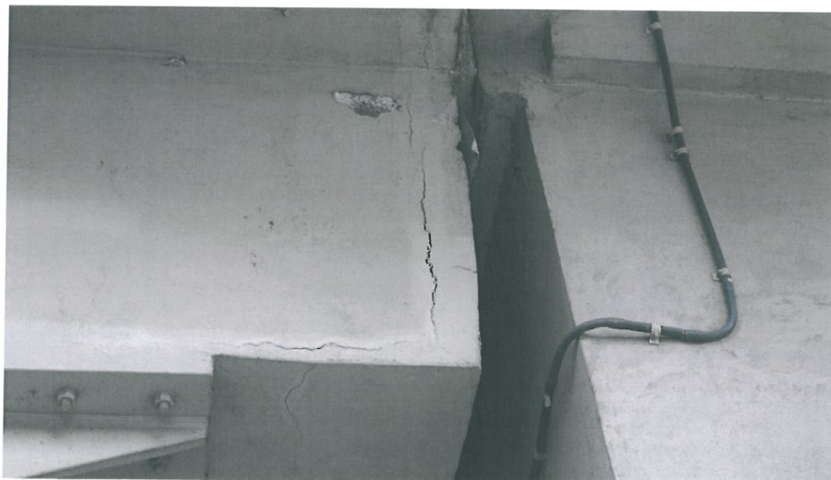
Fot. 124. Widoczne spękania powierzchni bocznej, dolnej, zewnętrznej ustroju nośnego w przęśle pomiędzy podporami P3-P4 estakady zachodniej spowodowane korozją prętów zbrojeniowych.
