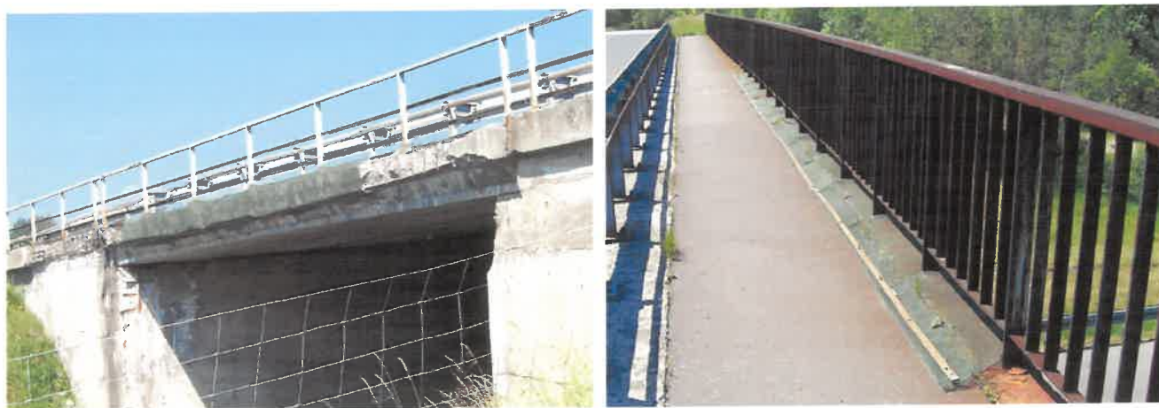
Rys. 14. Przykład tymczasowego zabezpieczenia siatką
