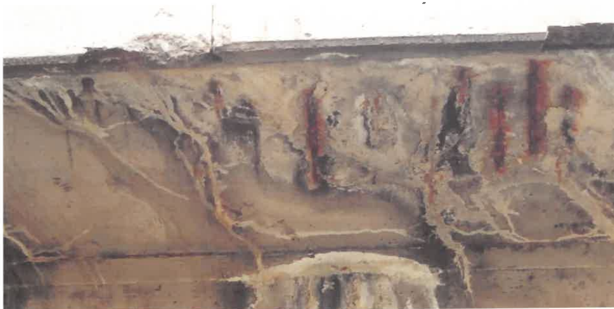
Rys. 11. Przecieki przez wspornik i korozja zbrojenia (zdjęcie z 2002r)
