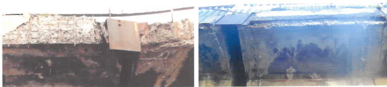
Rys. 13. Duże ubytki i odsłonięte zbrojenie gzymsów w rejonie dylatacji między segmentami
