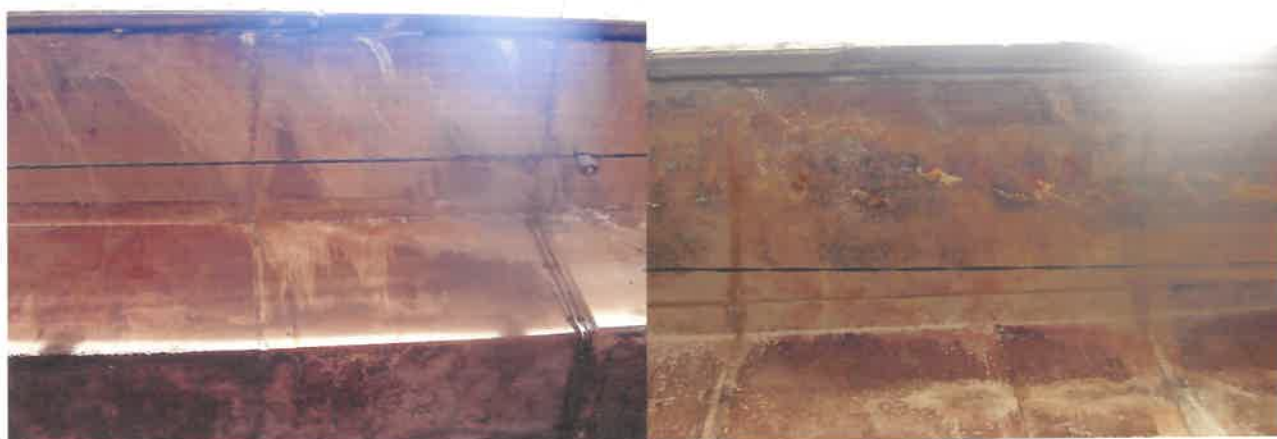
Rys. 6. Intensywne zacieki, wylugowania i rdzawe wykwity na spodzie wspornika
