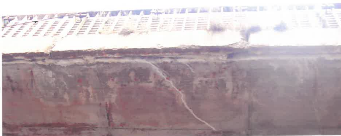
Rys. 7. Duże ubytki gzymsów, intensywne zacieki, pozostawione drewniane kliny oraz roślinność na stykach między prefabrykatami oraz wzdłuż krawędzi chodnika
