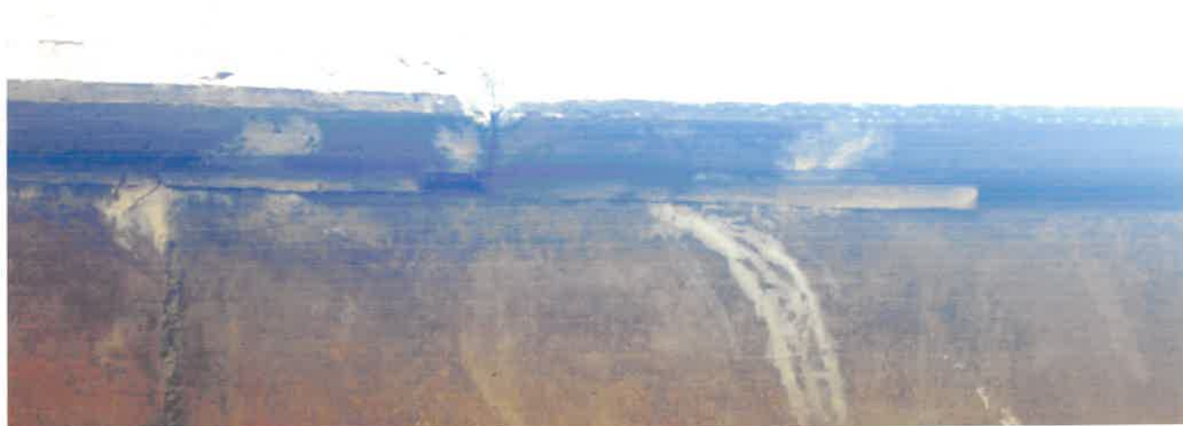
Rys. 9. Pozostawione kliny drewniane między gzymsem, a krawędzią wspornika
