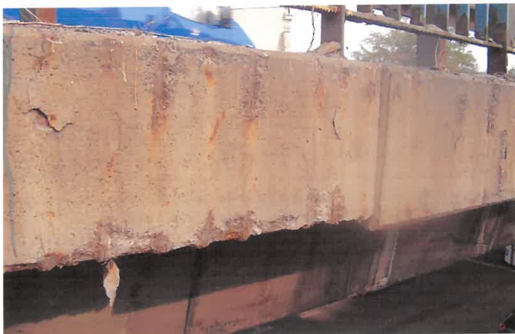
Rys. 5. Odpadające z gzymsu odłamki betonu i pęknięcie wzdłuż dolnej krawędzi
