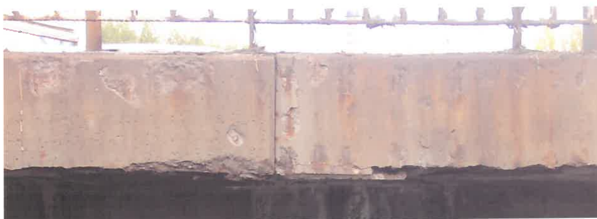
Rys. 12. Spękania i ubytki w dolnej części gzymsów (to samo miejsce w 2006r)
