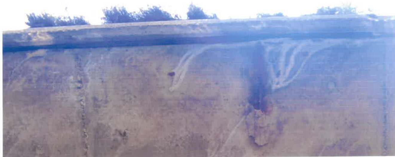
Rys. 10. Przepieki przez wspornik oraz roślinność na styku gzymsu i chodnika
