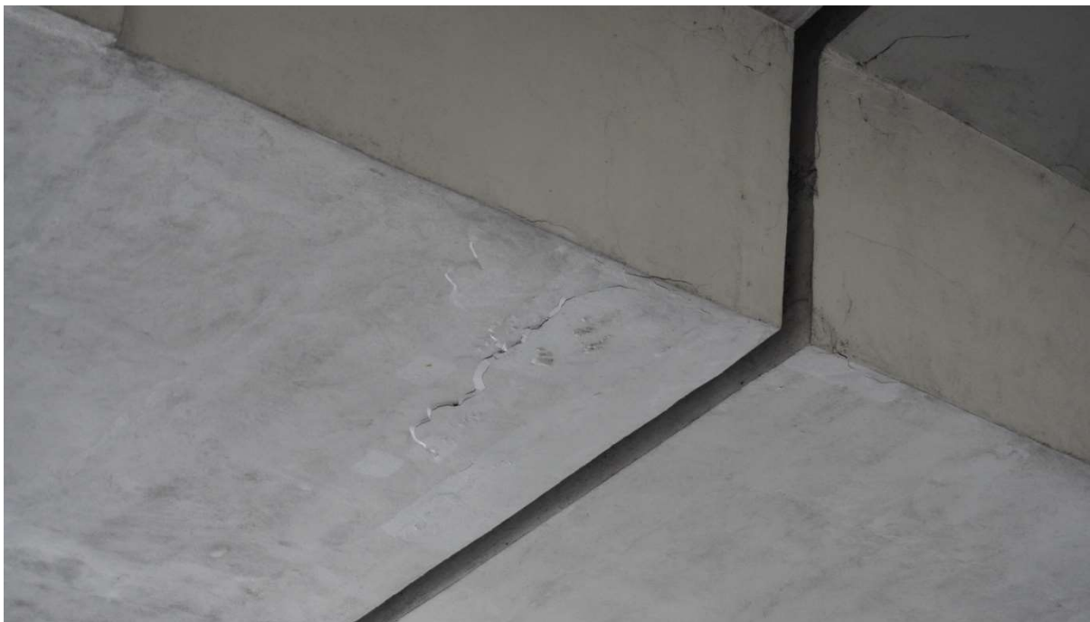
Fot. 23. Widoczne odspojenia dolnej powierzchni oraz spękania powierzchni bocznej ustroju nośnego w przęśle 3 od strony wewnętrznej na estakadzie wschodniej spowodowane korozją prętów zbrojeniowych.
