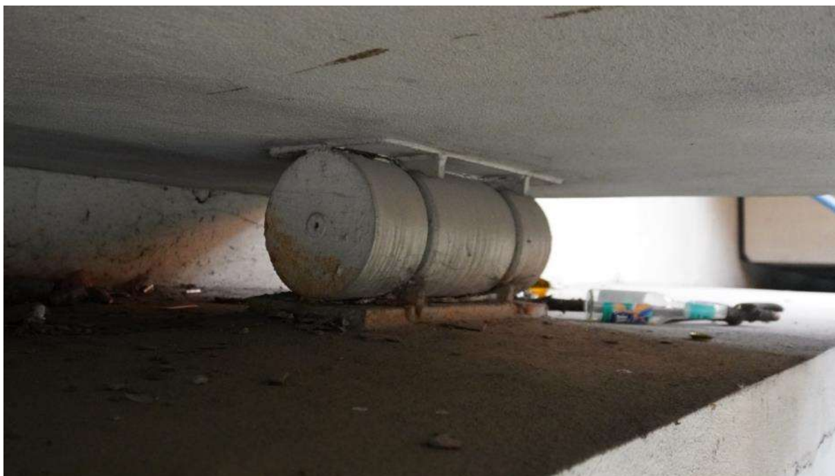
Fot. 32. Widoczne ogniska korozyjne na łożysku wałkowym stalowym zamontowanym na przyczółku od strony Katowic spowodowane niewłaściwym wykonaniem zabezpieczenia antykorozyjnego.
