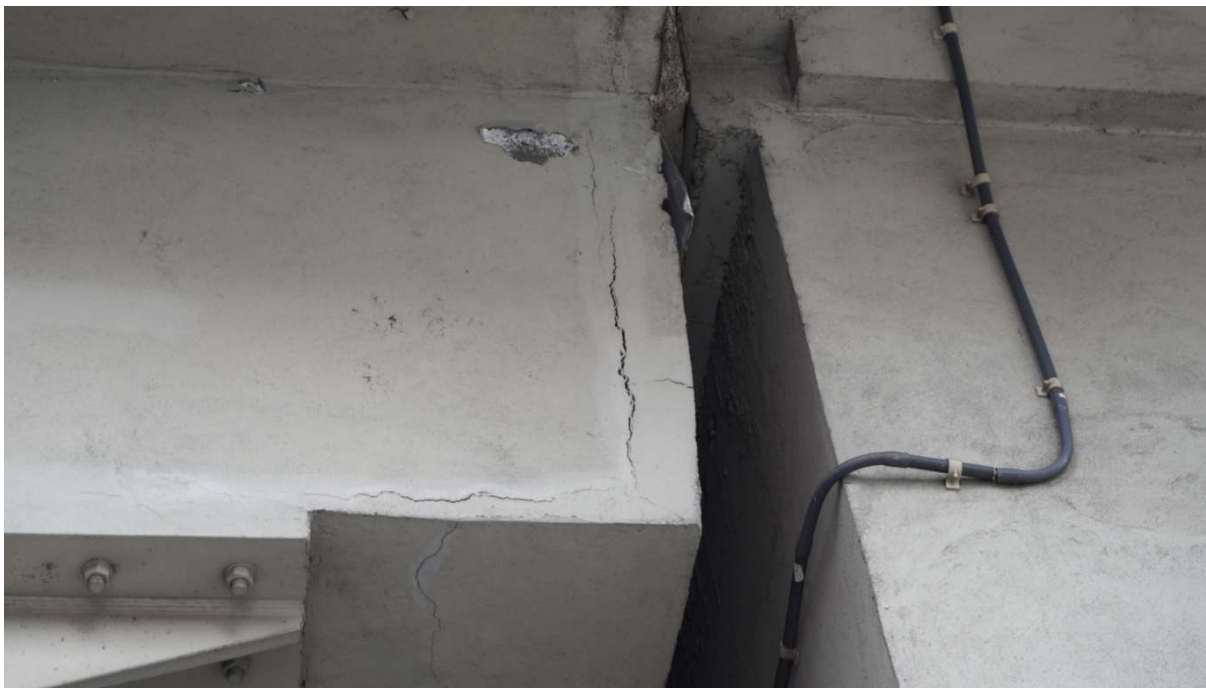
Fot. 29. Widoczne spękania powierzchni bocznej i dolnej ustroju nośnego w przęśle 4 od strony zewnętrznej na estakadzie zachodniej spowodowane korozją prętów zbrojeniowych.
