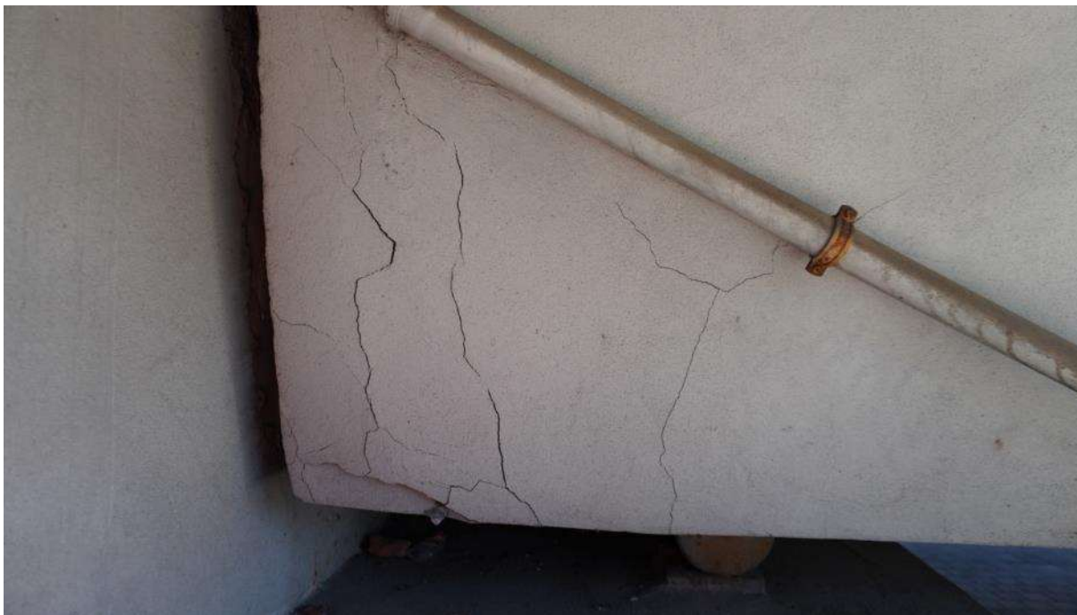
Fot. 15. Widoczne spękania na bocznej, zewnętrznej powierzchni ustroju nośnego w przęśle skrajnym od strony Katowic. Uszkodzenia spowodowane korozją prętów zbrojeniowych. Rozwartość rys do 1,1mm.
