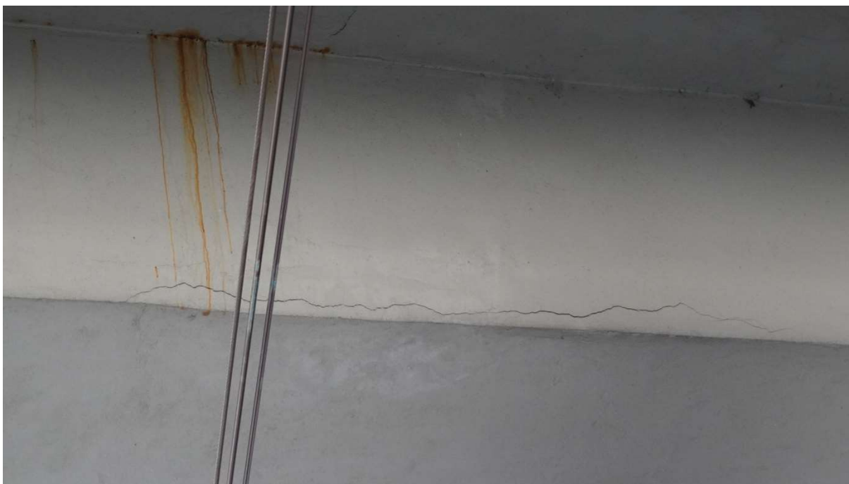
Fot. 22. Widoczne spękania powierzchni bocznej ustroju nośnego w przęśle 1 od strony wewnętrznej na estakadzie wschodniej spowodowane korozją prętów zbrojeniowych. Dodatkowo widoczne rdzawe zacieki na bocznej powierzchni spowodowane zbyt małą otuliną.
