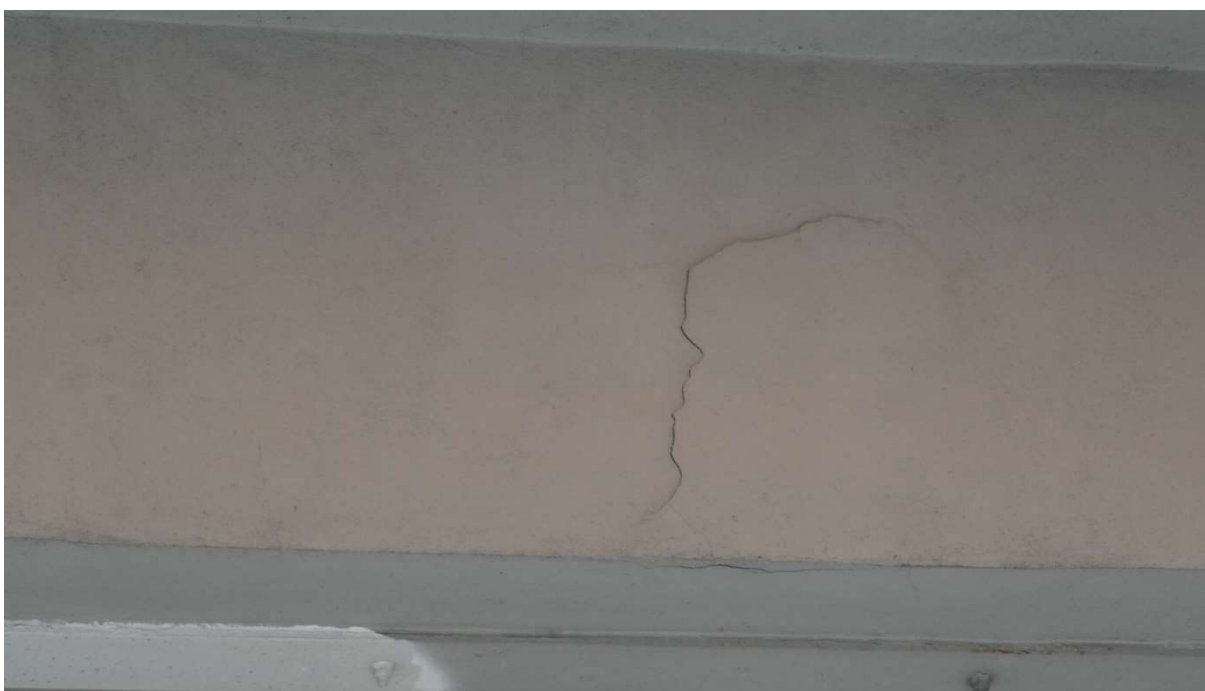
Fot. 24. Widoczne spękania powierzchni bocznej i dolnej ustroju nośnego w przęśle 11 od strony wewnętrznej na estakadzie wschodniej spowodowane korozją prętów zbrojeniowych.
