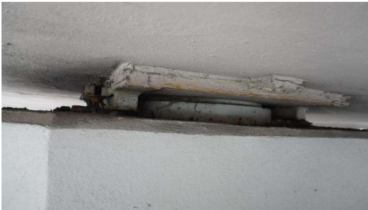
Fot. 31. Widoczne ogniska korozyjne na łożysku garnkowym stalowym jednokierunkowym na podporze 14 spowodowane niewłaściwym wykonaniem zabezpieczenia antykorozyjnego.
