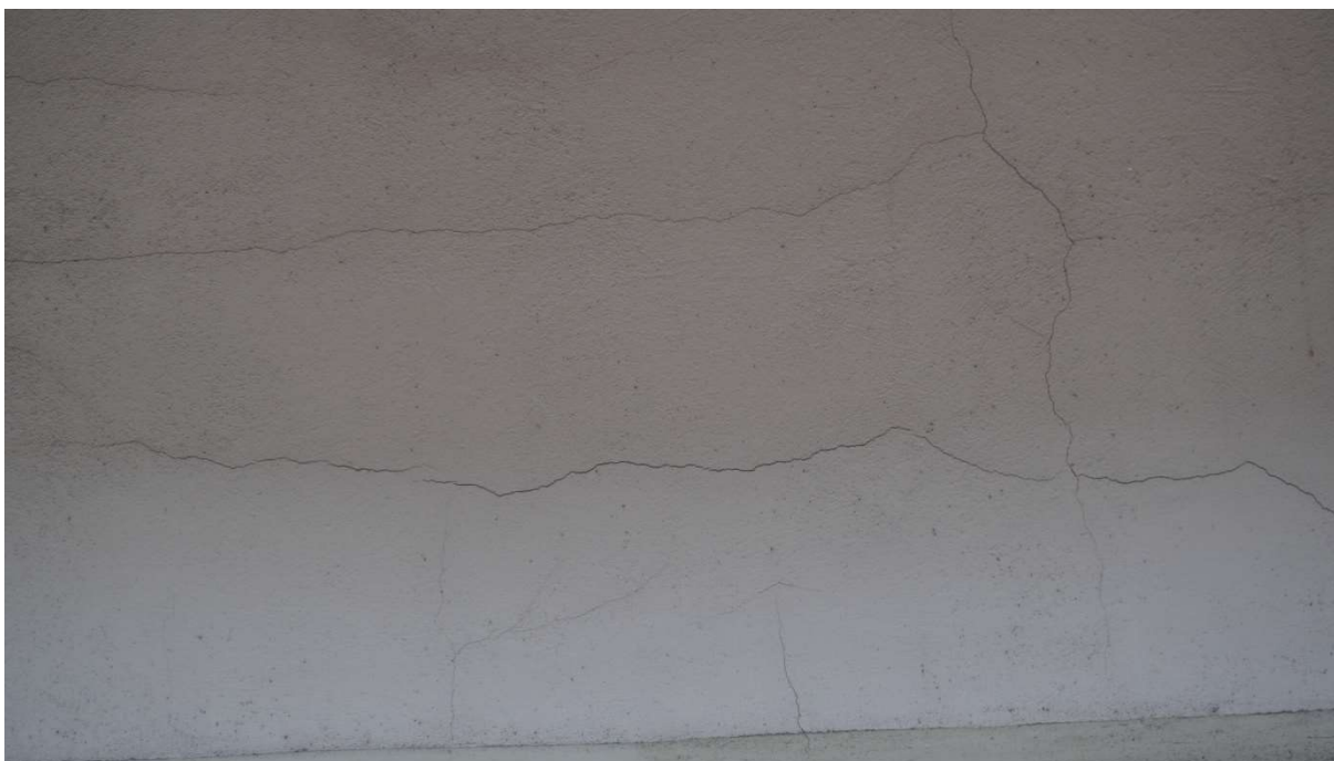
Fot. 26. Widoczne odspojenia oraz spękania powierzchni bocznej ustroju nośnego w przęśle 15 od strony wewnętrznej na estakadzie wschodniej spowodowane korozją prętów zbrojeniowych.
