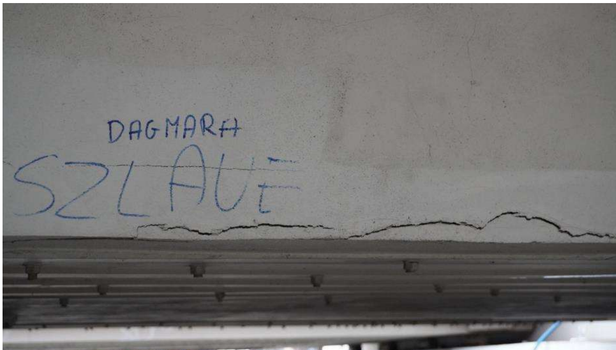
Fot. 19. Widoczne spękania powierzchni bocznej, zewnętrznej ustroju nośnego w przęśle skrajnym od strony Katowic spowodowane korozją prętów zbrojeniowych.
