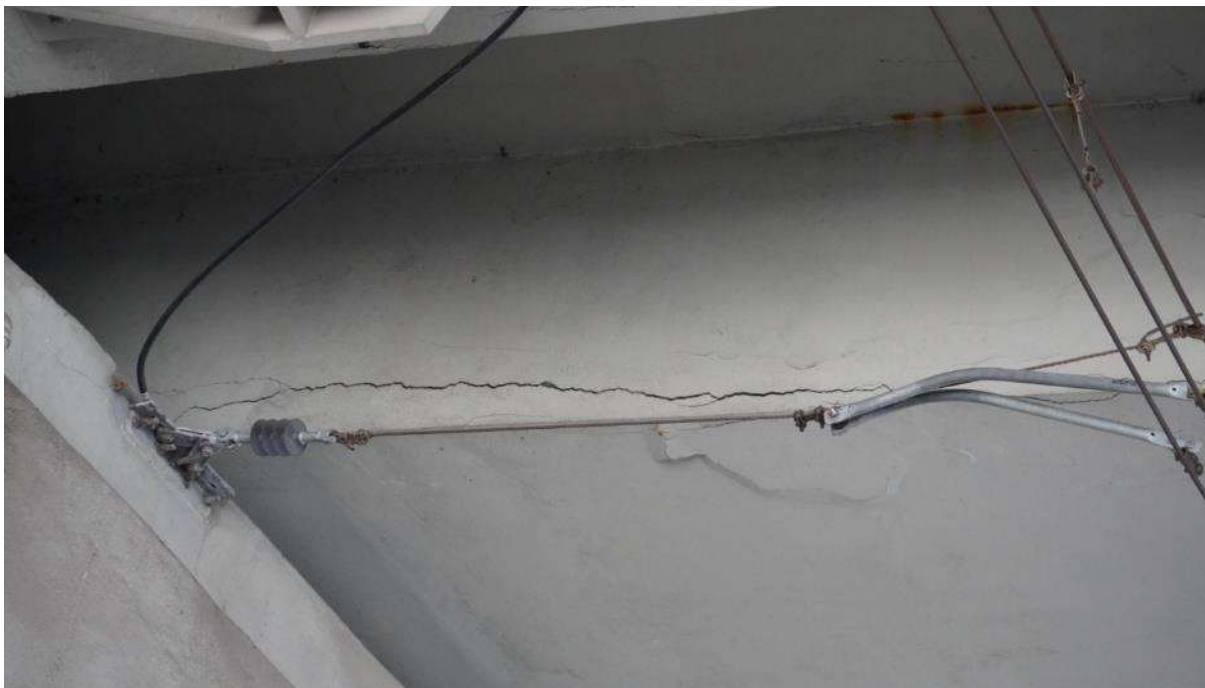
Fot. 17. Widoczne odspojenia dolnej powierzchni oraz spękania powierzchni bocznej ustroju nośnego w skrajnym przęśle od strony Bytomia na estakadzie wschodniej spowodowane korozją prętów zbrojeniowych.
