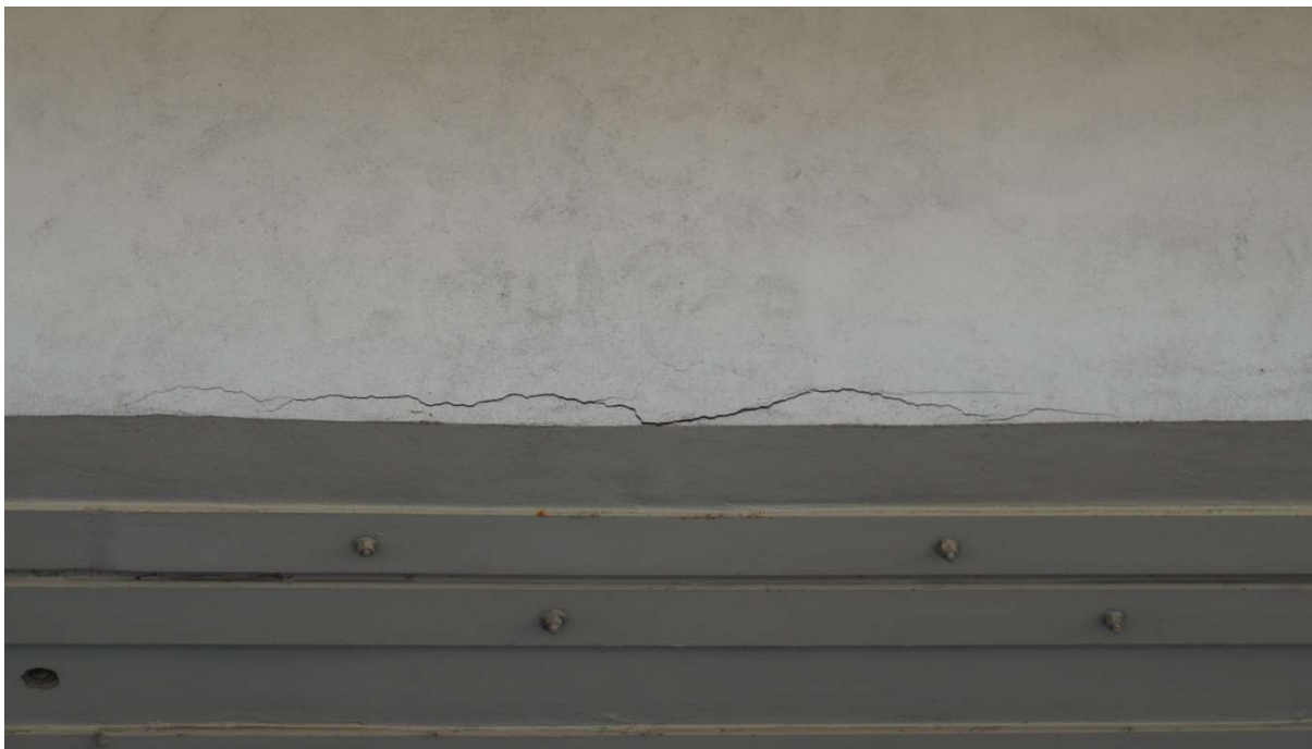
Fot. 21. Widoczne spękania powierzchni bocznej ustroju nośnego w przęśle 6 od strony zewnętrznej na estakadzie wschodniej spowodowane korozją prętów zbrojeniowych.
