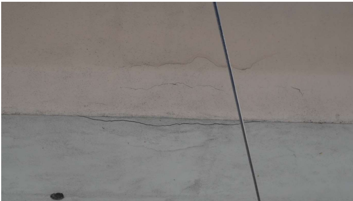
Fot. 25. Widoczne spękania powierzchni bocznej i dolnej ustroju nośnego w przęśle 12 od strony wewnętrznej na estakadzie wschodniej spowodowane korozją prętów zbrojeniowych.
