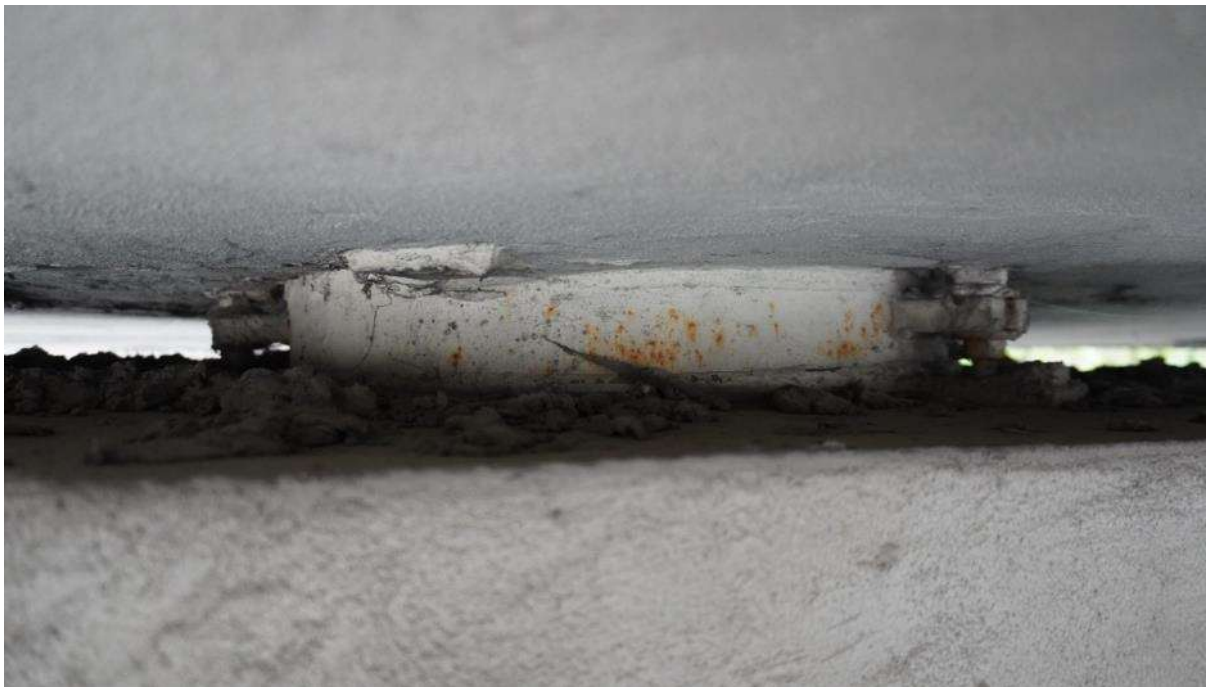
Fot. 30. Widoczne ogniska korozyjne na łożysku garnkowym stalowym stałym na podporze 13 spowodowane niewłaściwym wykonaniem lub dobranym systemem zabezpieczenia antykorozyjnego.
