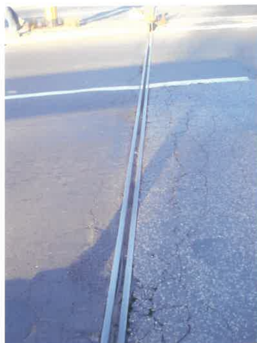
Fot. 20. Dylatacja od strony Bytomia. Widok dylatacji na jezdni Katowice – Bytom. Widoczne spękania nawierzchni jezdni.
