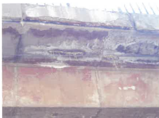
Fot. 3. Przęsło 6. Wspornik od zewnętrznej strony. Zacieki, białe wykwyty i stalaktyty. Ubytki betonu gzymsu. (Fot. arch. 12)
