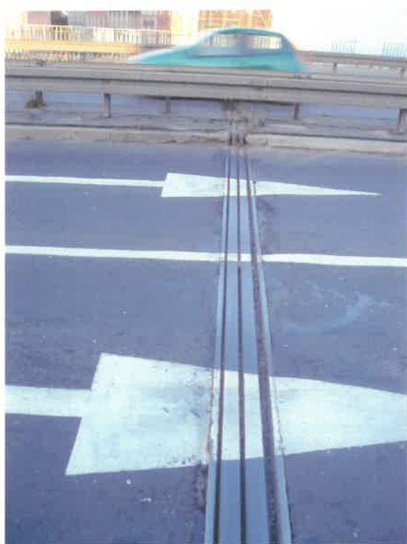
Fot. 23. Dylatacja w osi 3 – 4. Nitka Katowice – Bytom. Widoczne spękania nawierzchni przy dylatacji.
