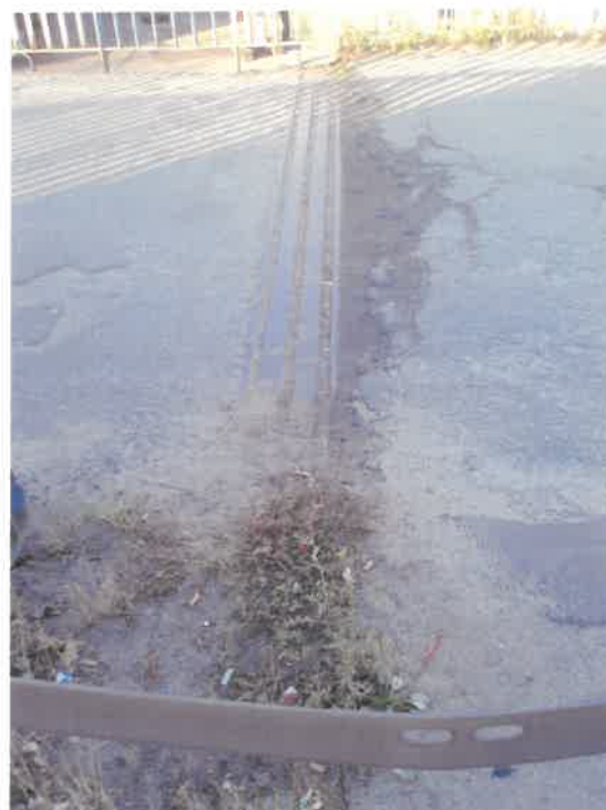
Fot. 22. Dylatacja w osi 3 – 4. Nitka Bytom-Katowice. Widok dylatacji na chodniku. Zanieczyszczenia roślinnością i spękania nawierzchni. (Fot. arch. 71)
