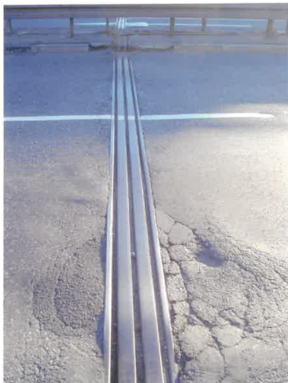
Fot. 21. Dylatacja w osi 3 – 4. Nitka Bytom-Katowice. Widok przy krawężniku zewnętrznym. Widoczne spękania nawierzchni przy dylatacji. (Fot. arch. 70)
