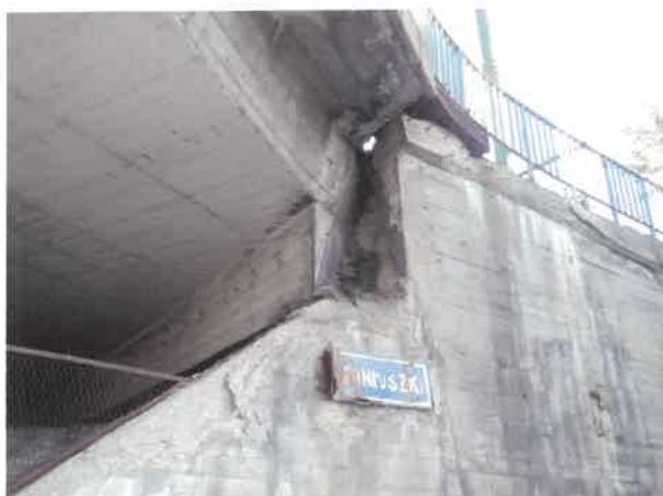
Fot. 13. Przyczółek od strony huty. Widok od strony Katowic. Widoczne zacieki i ubytki betonu gzymsu przyczółka. (Fot. arch. 57)
