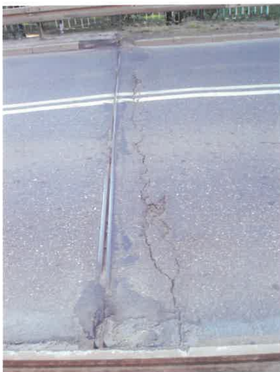
Fot. 29. Dylatacja od strony parku. Widok na dylatację przy krawężniku od strony Katowic. Widoczne spękania nawierzchni. (Fot. arch. 79)
