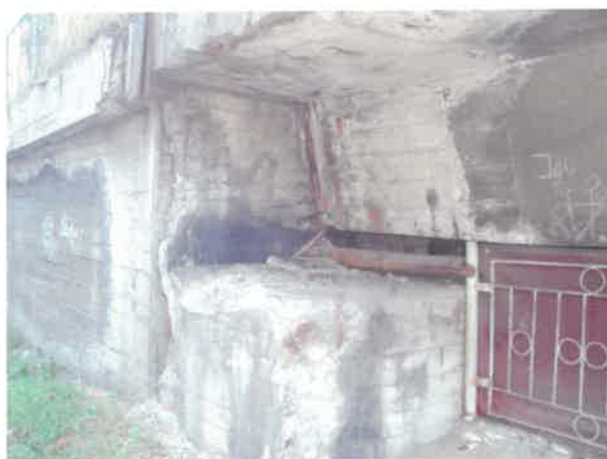
Fot. 15. Przyczółek pod nitką Katowice – Bytom. Widok od strony zewnętrznej. Widoczne spękania i ubytki betonu. (Fot. arch. 61)
