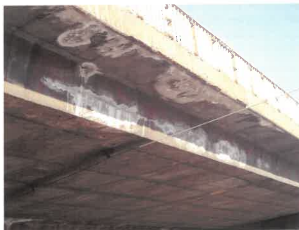
Fot. 7. Przęsło 10a. Widok od zewnętrznej strony w rejonie podpory 12a i środka przęsła. Widoczne zacieki na wsporniku i pow. bocznej. (Fot. arch. 21)
