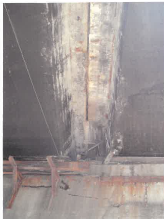
Fot. 12. Przyczółek pod nitką Katowice - Bytom. Pozostawione deskowanie wspornika. (Fot. arch. 56)
