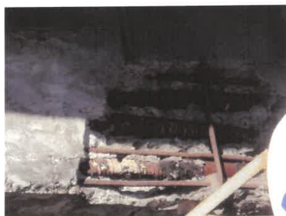
Fot. 8. Przęsło 11a. Widok od zewnętrznej strony na boczną pow. Odsłonięte korodujące kable, niezabezpieczone po odkrywce. (Fot. arch. 30)
