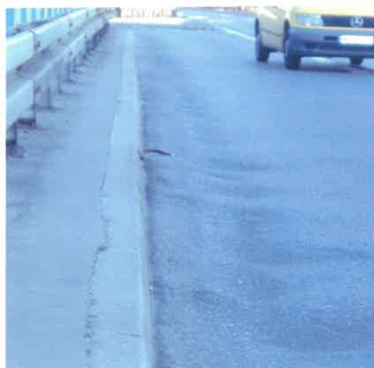
Fot. 32. Koleiny nawierzchni jezdni na prześle 12.
