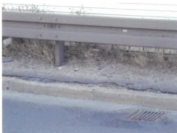
Fot. 31. Nawierzchnia chodnika zewnętrznego – widoczne odspojenia nawierzchni i zanieczyszczenia roślinnością
