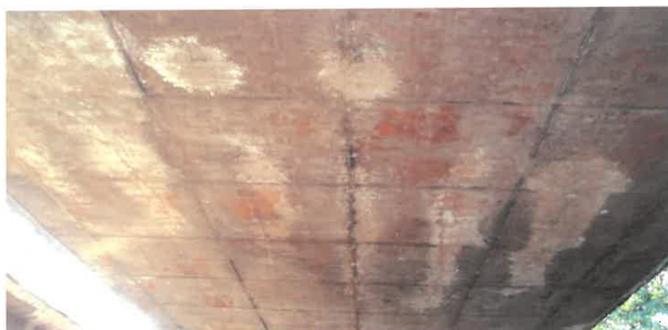
Fot. 5. Przęsło 9. Widok na spód płyty w rejonie środka przęsła. Widoczne zacieki w miejscach prowadzenia rur. (Fot. arch. 17)
