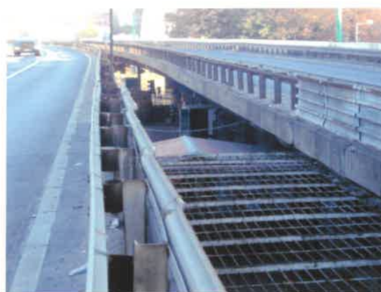
Fot. 36. Widok na przestrzeń pomiędzy nitkami estakady w rejonie prześel 12 i 13. Zwraca uwagę brak sztywnych barieroporęczny na krawcach estakady.
