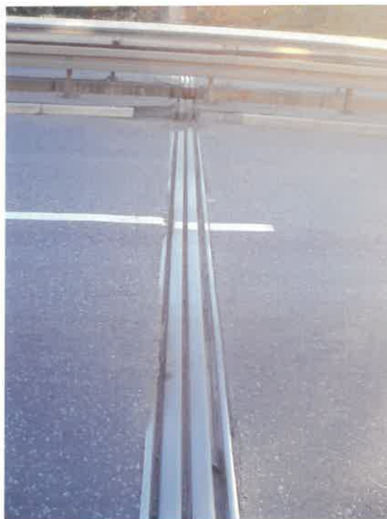
Fot. 28. Dylatacja w osi 9 – 10. Widok na dylatację w rejonie krawężnika wewnętrznego. (Fot. arch. 77)
