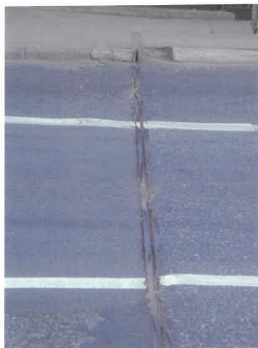
Fot. 30. Dylatacja od strony Katowic. Nitka Bytom-Katowice. Widoczne spękania nawierzchni. (Fot. arch. 80)
