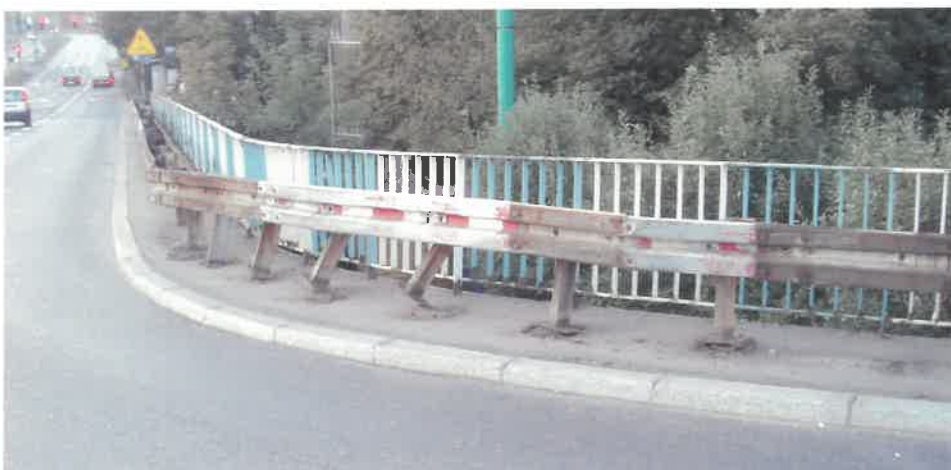
Fot. 34. Bariery energochłonne w rejonie zjazdu parkowego. Połamane słupki, wygięta taśma prowadząca.
