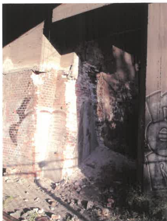
Fot. 11. Przyczółek pod nitką Katowice – Bytom. Widok od strony zewnętrznej. Widoczne ubytki betonu. (Fot. arch. 54)
