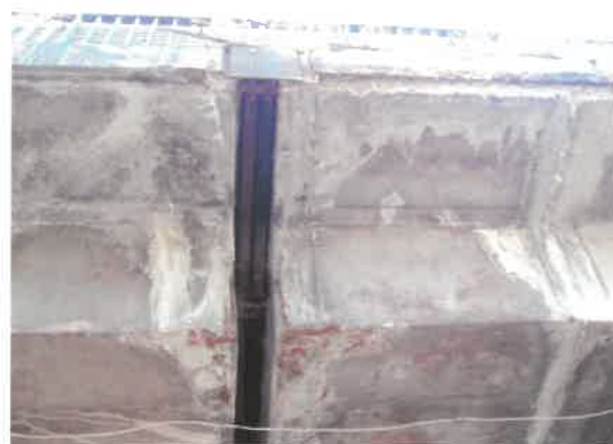
Fot. 26. Dylatacja w osi 9 – 10. Nitka Katowice – Bytom. Widok z boku od strony zewnętrznej. Widoczne zacieki i zanieczyszczenia. (Fot. arch. 76)
