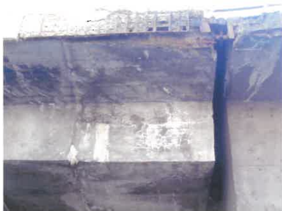
Fot. 1. Przęsło 3 i 4. Widok od zewnętrznej strony na dylatację pomiędzy segmentami 1 i 2. Widoczne zacieki i ubytki betonu w desce gzymsowej. (Fot. arch. 6)
