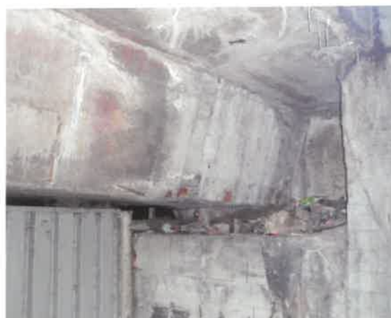
Fot. 16. Przyczółek pod nitką Bytom – Katowice. Widok od zewnętrznej strony. Zaśmiecona nisza podłożyskowa. (Fot. arch. 62)
