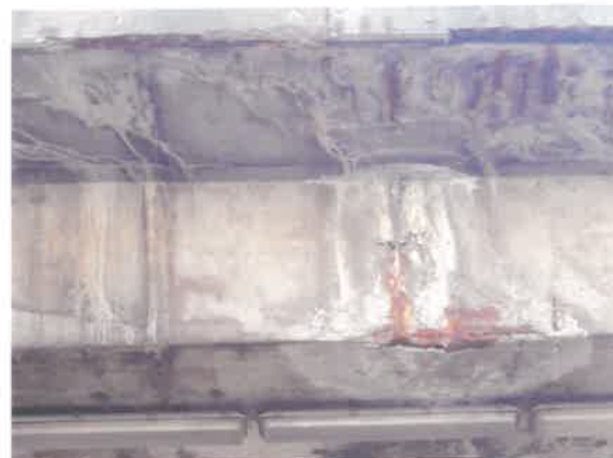
Fot. 2. Przęsło nr 5. Widok od zewnętrznej strony na boczną pow. płyty w rejonie środka przęsła. Widoczne skorodowane zbrojenie, zacieki i ubytki betonu. (Fot. arch. 9)
