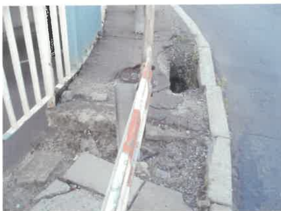
Fot. 17. Dylatacja od strony huty. Widok z góry na chodnik od strony Katowic. Dziura w miejscu dylatacji. (Fot. arch. 68)
