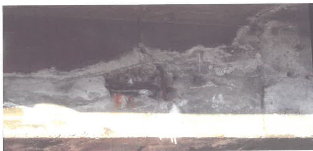
Fot. 9. Przęsło 11a. Widok od zewnętrznej strony na boczną pow. płyty w rejonie podpory 12a. Ślady wierceń odkrywkowych. Korodujące, niezabezpieczone po odkrywce kable. Zacieki i białe wykwity. (Fot. arch. 29)
