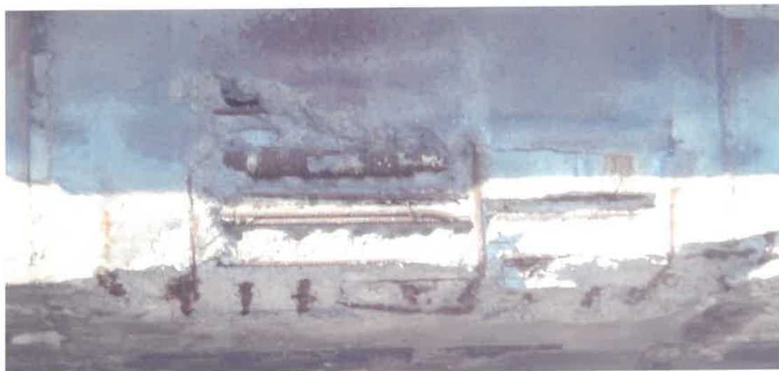
Fot. 10. Przęsło 12a. Widok od zewnętrznej strony na boczną pow. płyty w rejonie środka przęsła. Widoczne skorodowane kable, niezabezpieczone po odkrywce oraz podłużne rysy biegnące wzdłuż trasy kabli. Spękana i odspojona krawędź płyty. (Fot. arch. 34)
