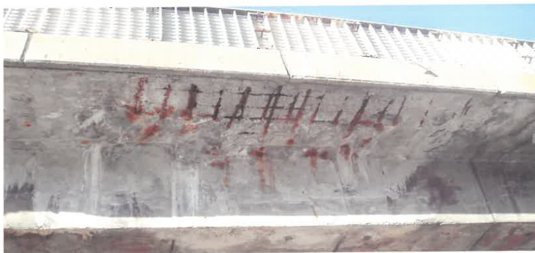
Fot. 6. Przęsło 9a. Widok od zewnętrznej strony na wspornik i boczną pow. płyty w rejonie podpory 11a. Widoczne zacieki i ubytki betonu na wsporniku. (Fot. arch. 18)
