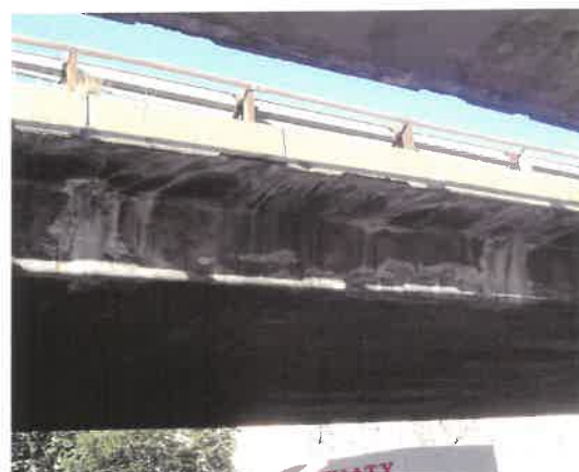
Fot. 4. Przęsło 9. Wspornik od wewnętrznej strony. Widoczne zacieki i białe wykwyty.
