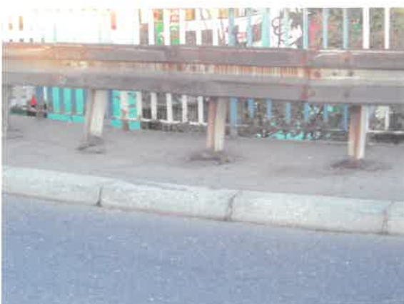
Fot. 35. Bariery energochłonne w rejonie zjazdu parkowego. Połamane słupki, wygięta taśma prowadząca.
