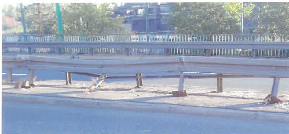
Fot. 33. Bariery energochłonne w pasie dzielącym od strony Bytomia. Połamane słupki, pognięta taśma prowadząca.
